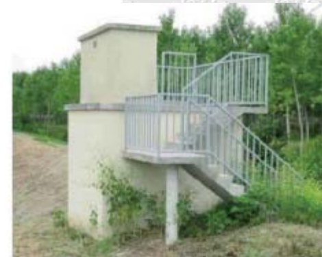
Figura 8. Transformador eléctrico sobrelevado situado en la zona inundable del Rio Garona.
