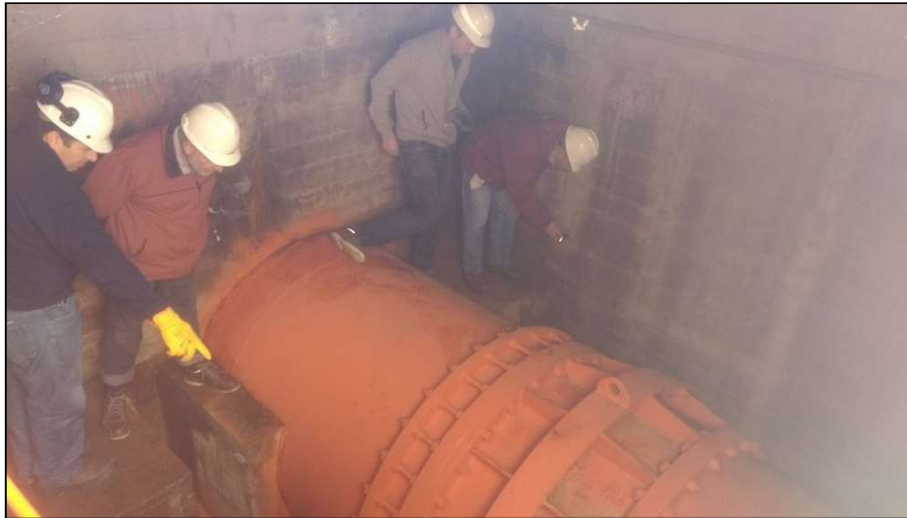
Válvula del descargador de fondo de la presa Aisol. Ensayo de apertura hasta un 55% del total. Fuertes ruidos por cavitación e inundación por filtraciones.
