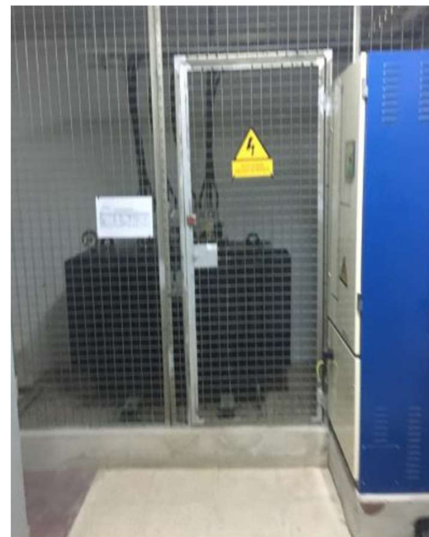
Centro de transformación
