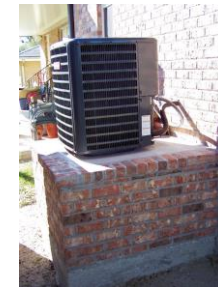
Sistema de calor/frío situado sobre nicho Homeowner's Guide to Retrofitting
