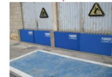
CENTRO DE TRANSFORMACION
