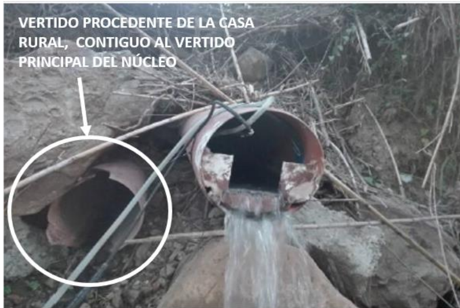
Ilustración 4. Vertido procedente de casa rural contiguo al vertido principal de El Colmenar
