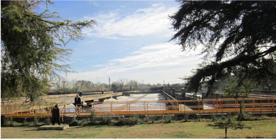
70: Reactor biológico de turbinas
