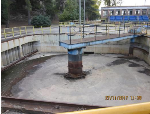
7: Decantadores originarios del año 1934
