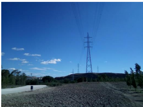
Línea eléctrica que atraviesa la zona verde de reciente implantación y llega a la Subestación
