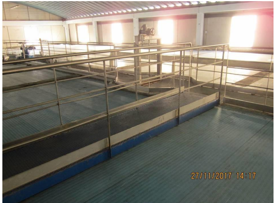
61: Decantadores primarios cubiertos
