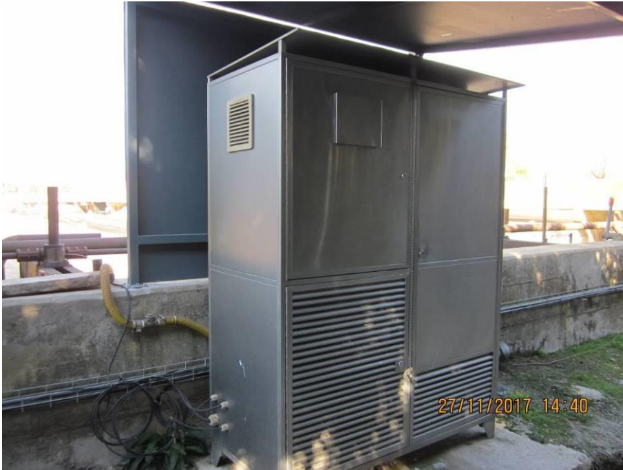
74: Armario con sistema de respirometría de control de aireación
