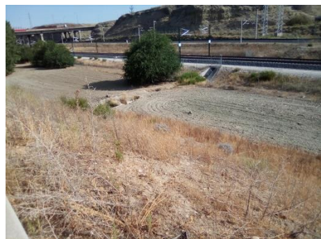
Obra de drenaje de la plataforma ferroviaria que conecta con el Real Canal del Manzanares
