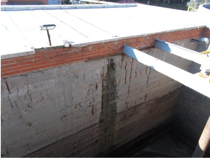
Ilustración 118: Depósito fangos primarios
