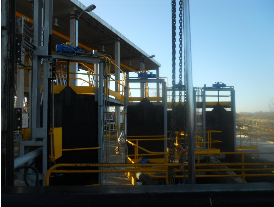
Ilustración 81: compuertas canales de rejillas y tamices
