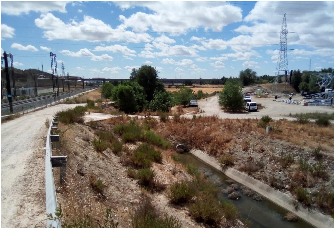
Vista general de izquierda a derecha: plataforma ferroviaria, acceso a paso superior, Real Canal del Manzanres, zona de obras de instalación de apoyo para línea eléctrica
