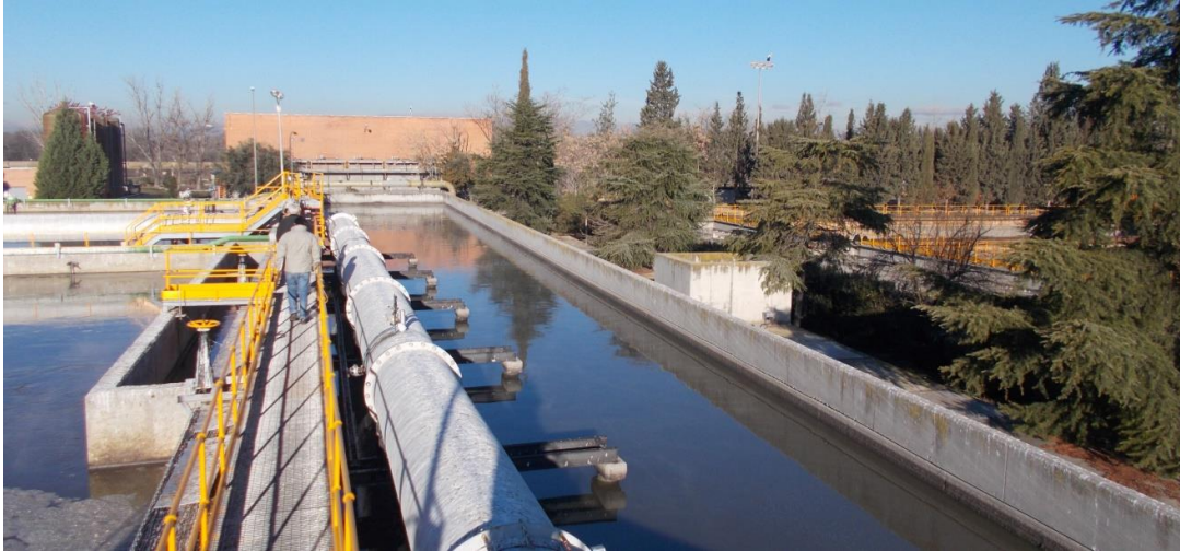
Ilustración 101: Canal de entrada a reactores biológicos
