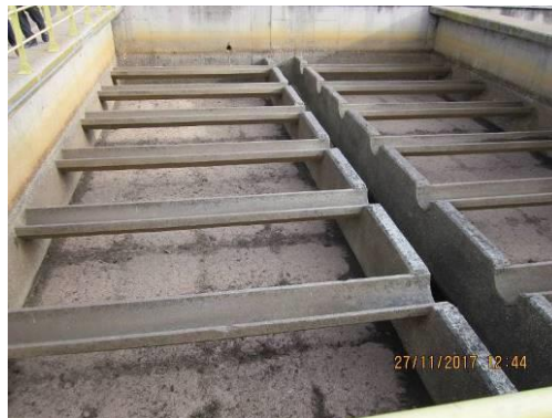
48: Filtro de arena vacío
