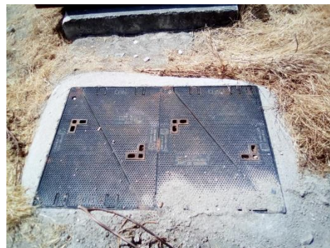
Vista de arqueta de Red Eléctrica de España
