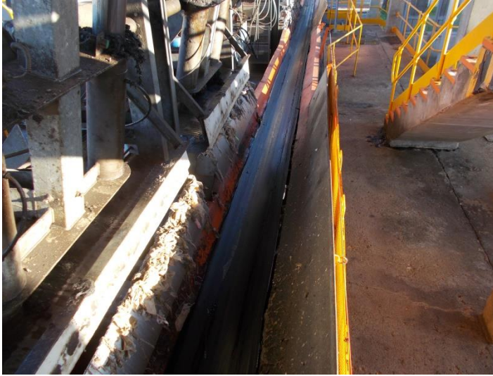
Ilustración 85: Cinta de descarga residuos rejas
