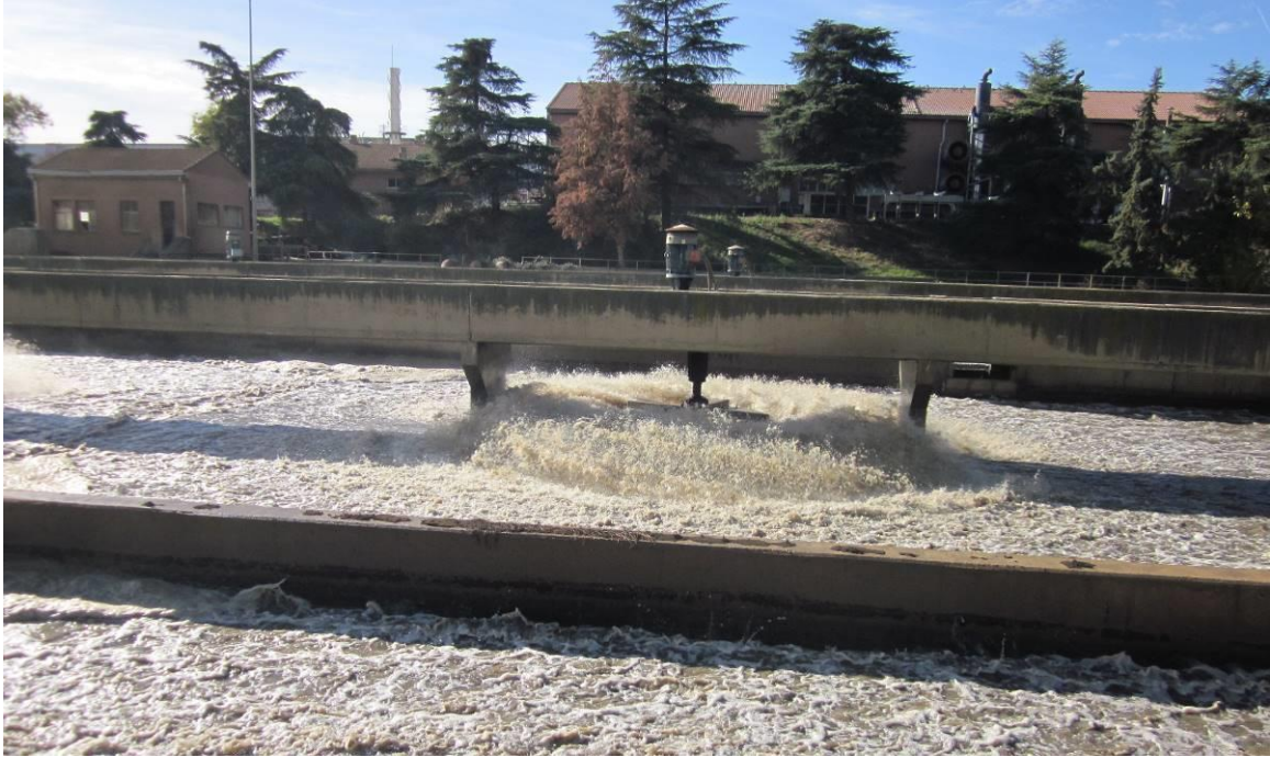
72: Turbina de reactor
