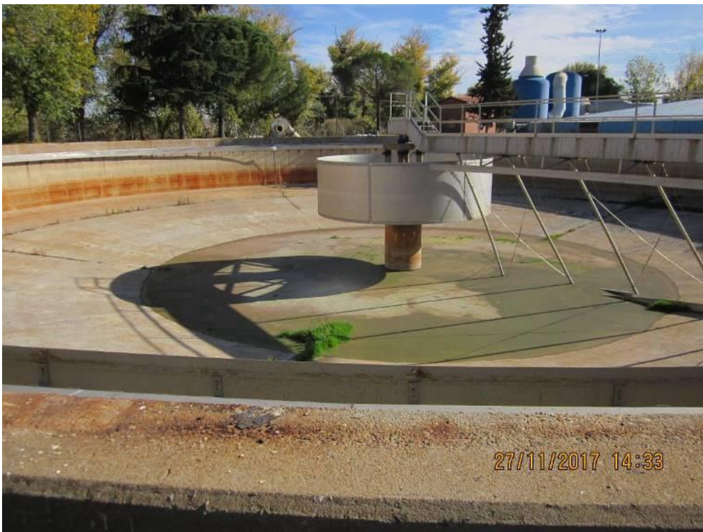
69: Decantador fuera de uso
