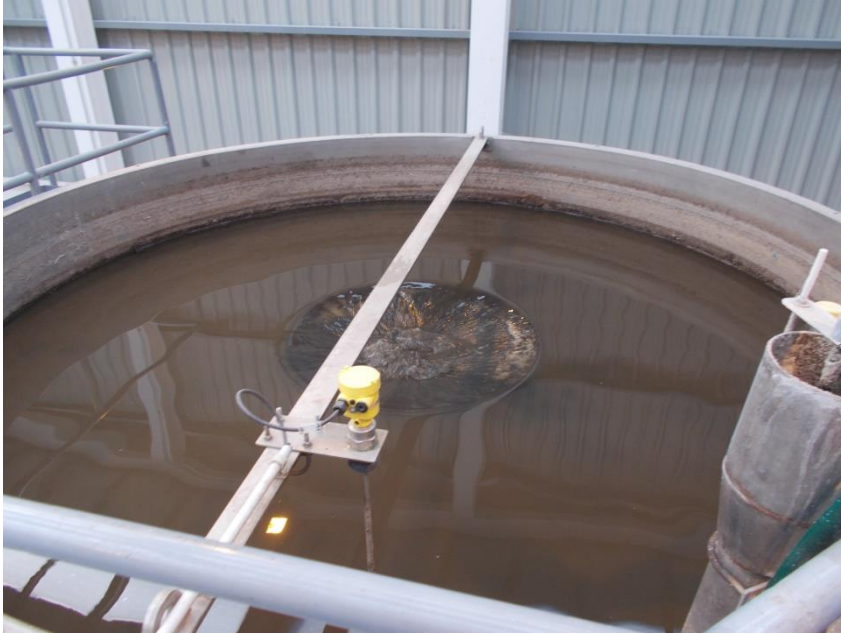
Ilustración 141: Parte superior de reactor
