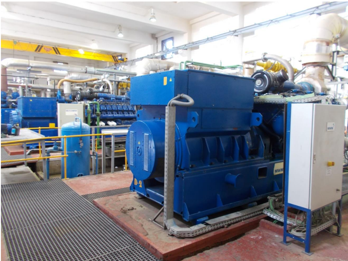
Ilustración 134: Sala de motogeneración
