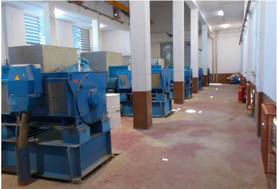
Ilustración 106: Sala de soplantes
