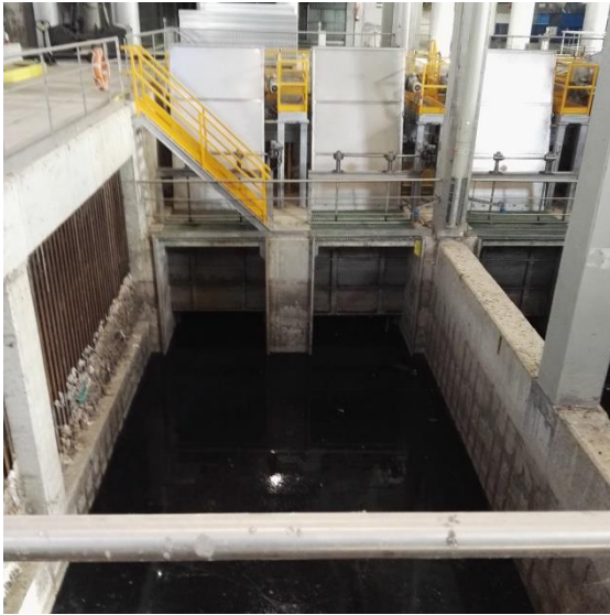
53: Pozo de gruesos
