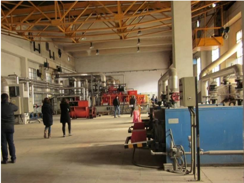
34: Nave de calderas y motores
