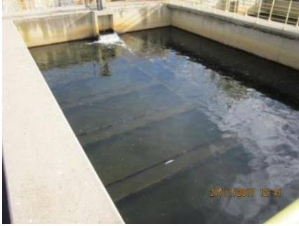
47: Filtro de arena
