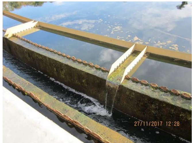
23: Salida de decantador
