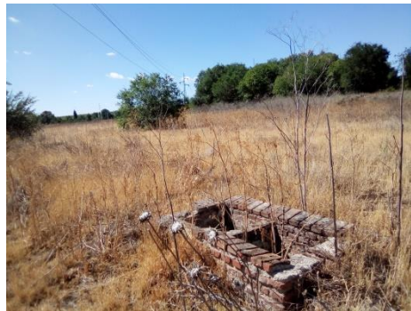
Arqueta abandonada en la parcela en la que se plantea ubicación de Tanque de Tormentas
