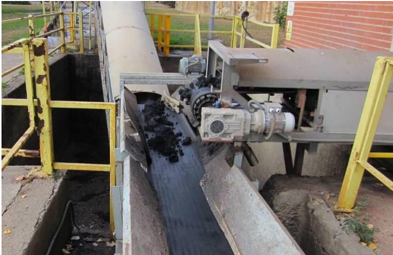
31: Salida de lodo deshidratado
