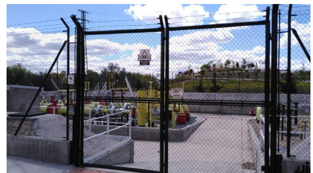
Instalaciones asociadas a gasoducto junto a las instalaciones de la Caja Mágica
