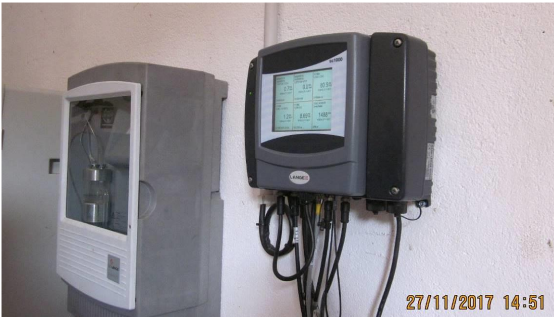
77: Sistema de control en línea de parámetros del efluente
