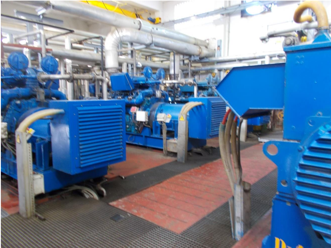
Ilustración 135: Sala de motogeneración
