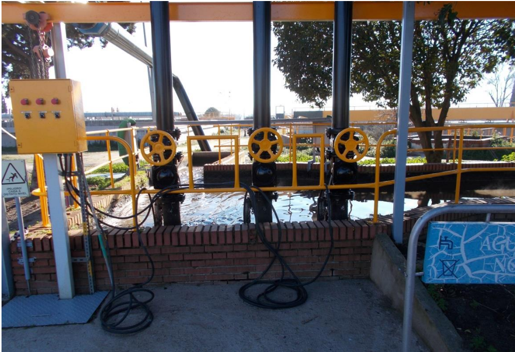
Ilustración 108: Bombeo de fangos en exceso
