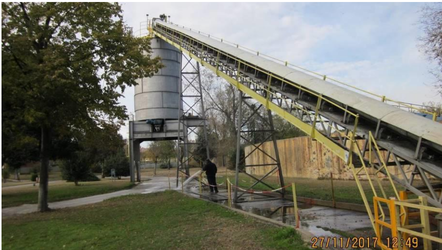
32: Silo de Lodos
