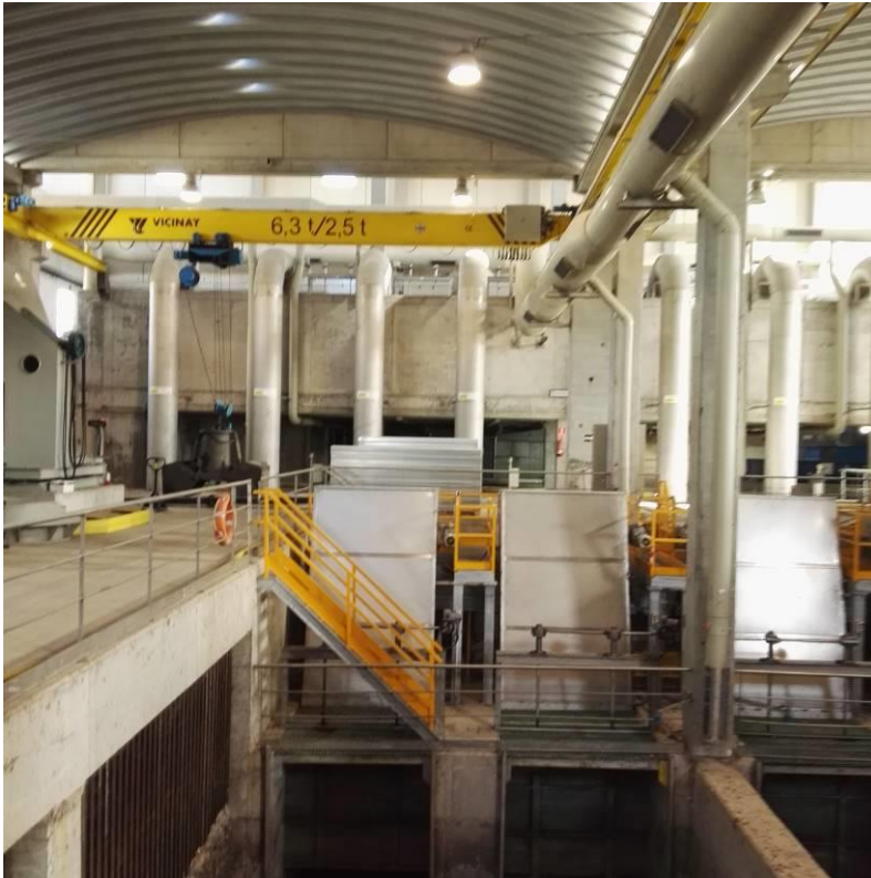
55: Rejas y bombeo de elevación
