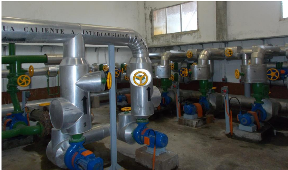
Ilustración 131: Sala bombas digestión
