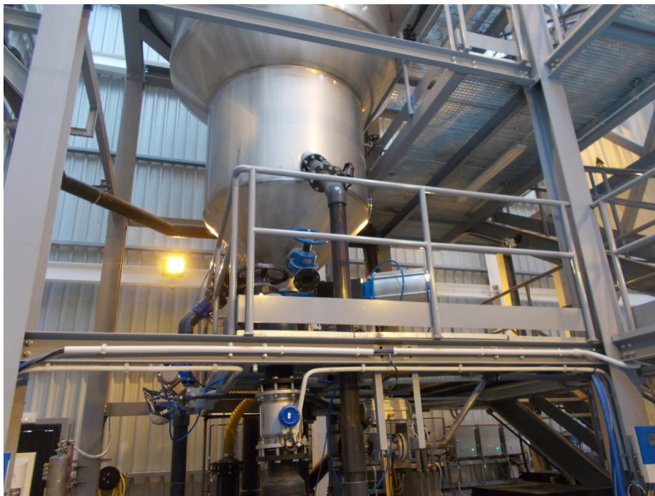
Ilustración 140: Reactor de estruvita
