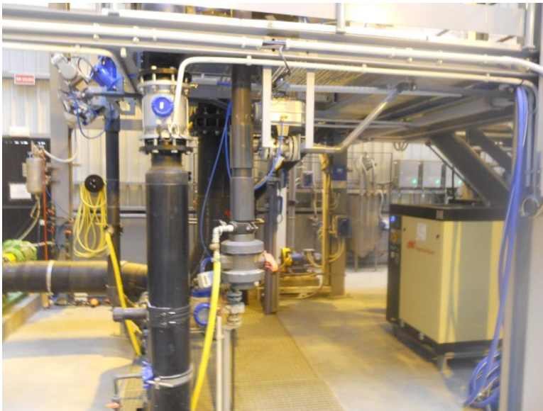
Ilustración 144: Parte inferior del reactor
