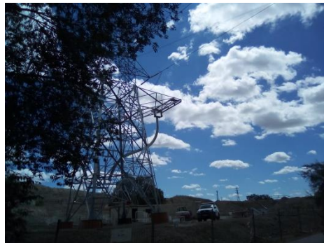
Montaje de apoyo eléctrico junto a la parcela propuesta para Tanque de Tormentas
