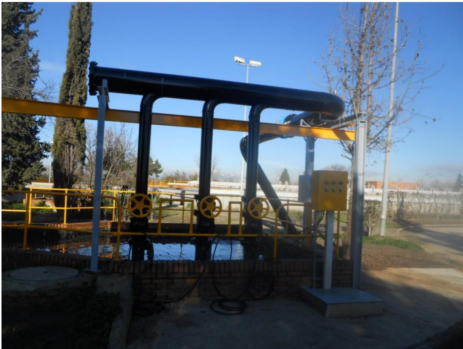
Ilustración 107: Bombeo de fangos en exceso
