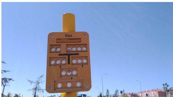
Señal de gasoducto en el Parque Lineal. Posible servicio afectado
