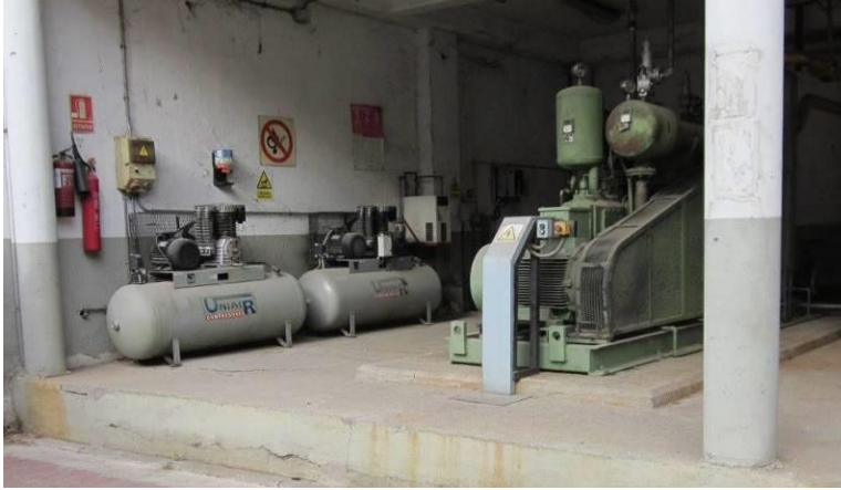
36: Compresores de gas
