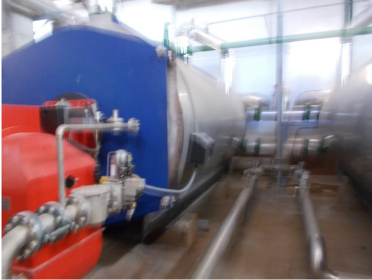
Ilustración 133: Caldera de biogás
