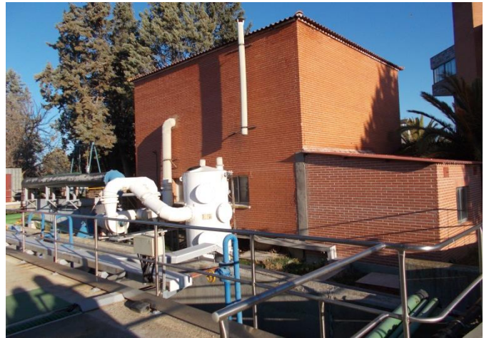
Ilustración 96: Purga de fangos primarios
