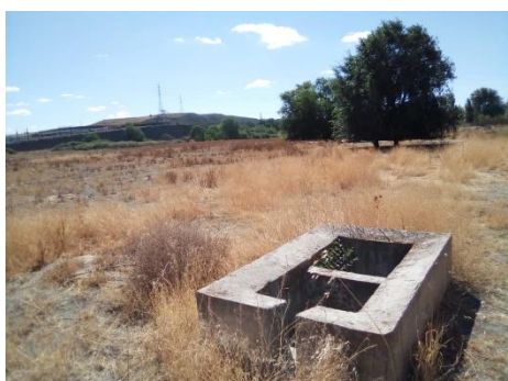
Arqueta abandonada en la parcela en la que se plantea ubicación de Tanque de Tormentas
