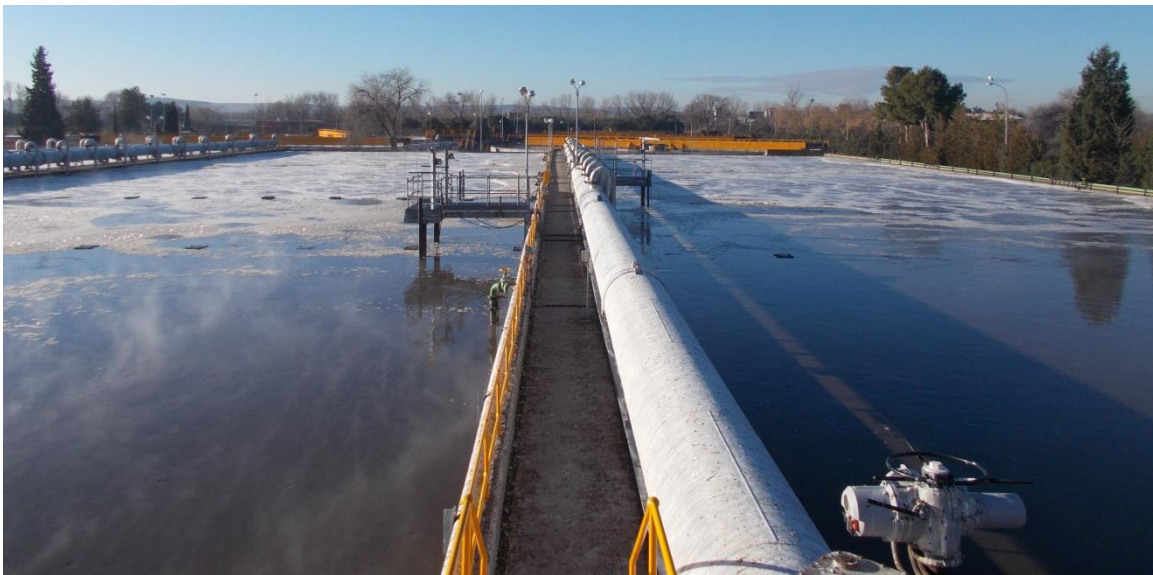
Ilustración 105: Vista de dos reactores
