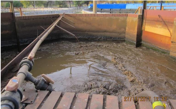
22: Dosificación de FeCl_3 antes de decantación en arqueta de reparto
