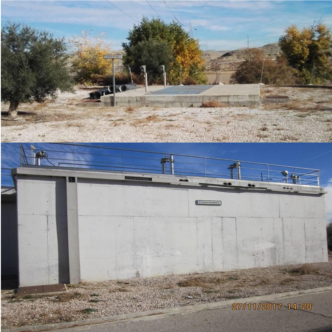
59: Arqueta de salida de pretratamiento y de reparto a decantación primaria
