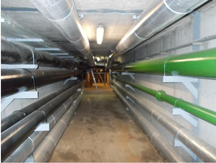
Ilustración 128: Galería de servicios
