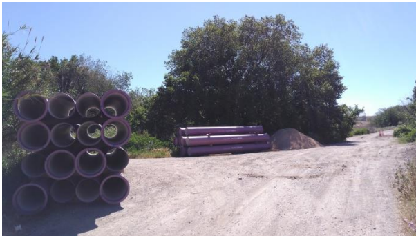
Zona de acopio de tuberías para obra de conducción de aguas regeneradas. Como se verá más adelante estas obras se están ejecutando en el camino por lo que en el futuro podría ser un servicio afectado
