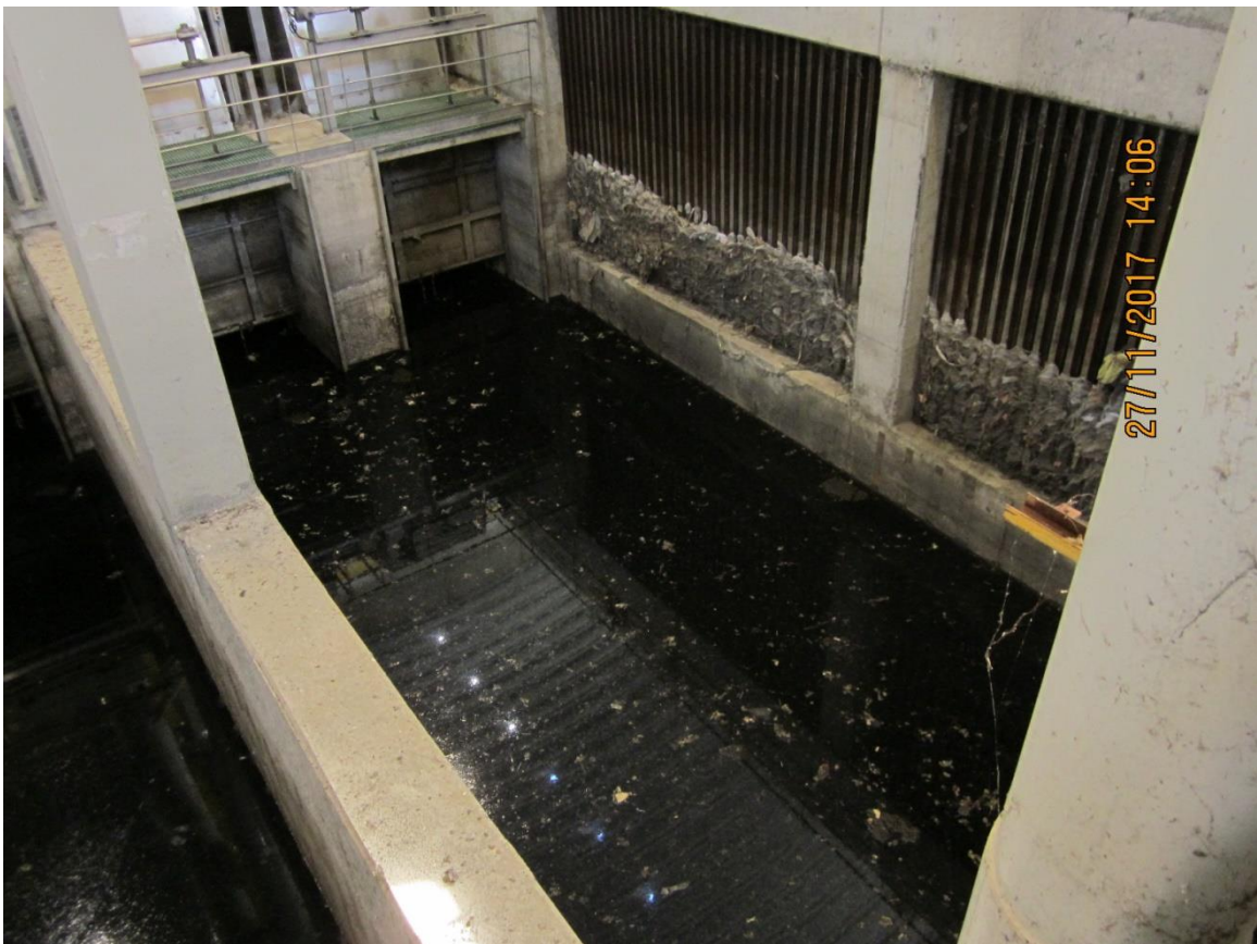
54: Pozo de gruesos
