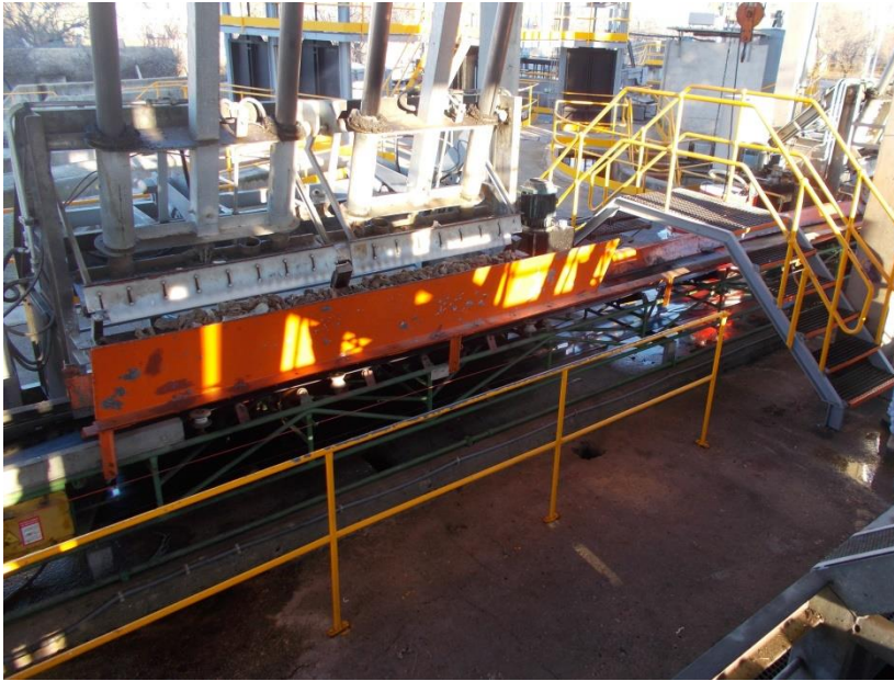
Ilustración 87: Cinta recogida residuos tamicés
