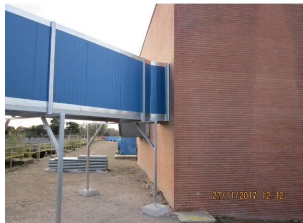
17: Sala de soplantes y colector de aire comprimido
