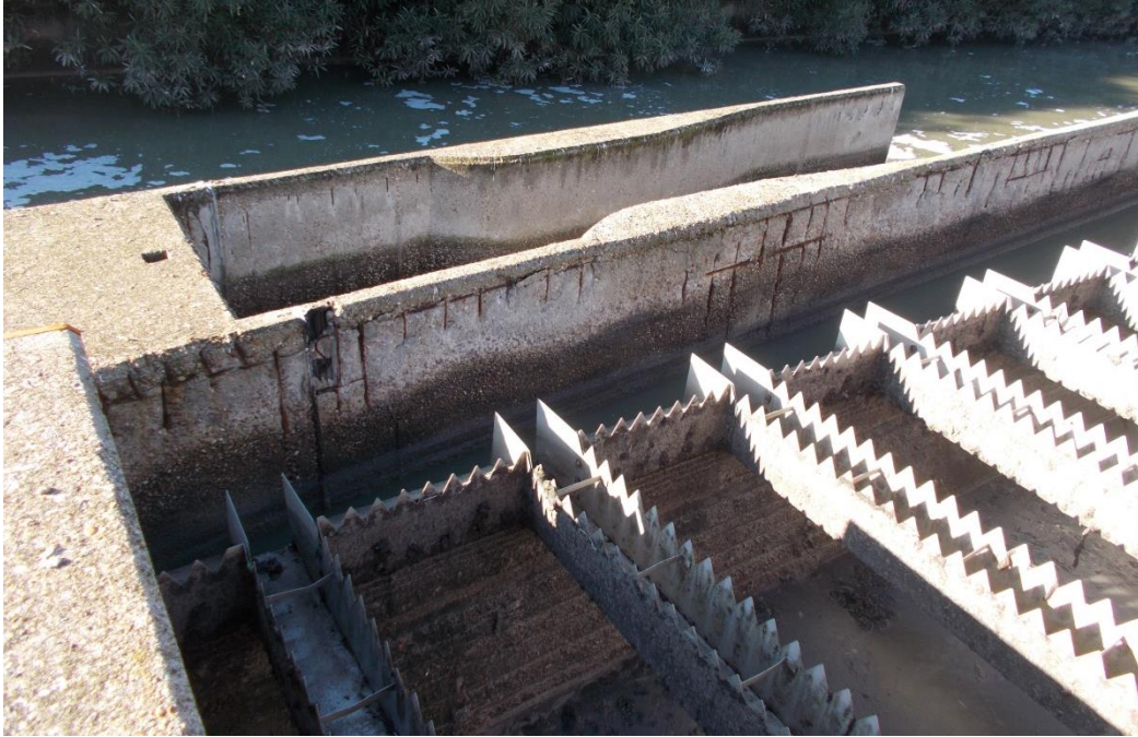
Ilustración 93: Salida decantadores primarios
