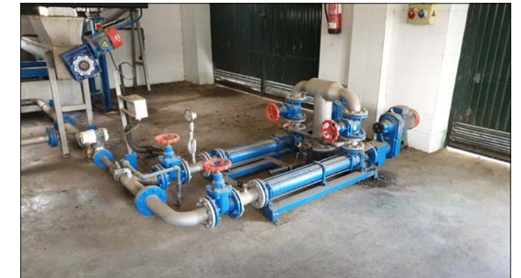
FOTOGRAFÍA 4: GRUPO MOTOBOMBA DE TORNILLO HELICOIDAL BOMBEO DE FANGOS ESPESADOS A DESHIDRATACIÓN
