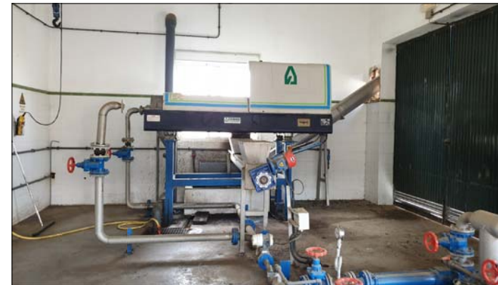
FOTOGRAFÍA 3: CENTRÍFUGA DESHIDRATACIÓN DE FANGOS ESPESADOS
