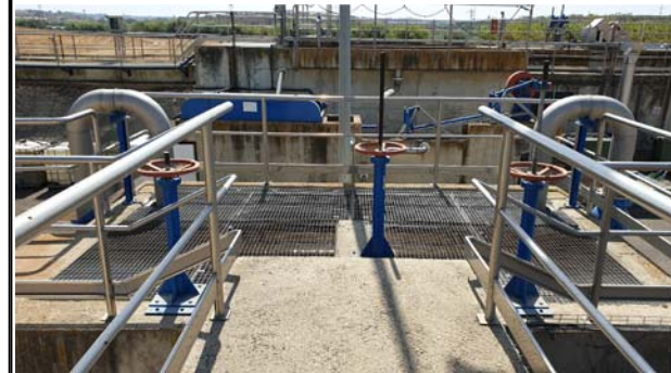
COMPUERTAS MURALES. ACCIONAMIENTO MANUAL (1 y 2)
