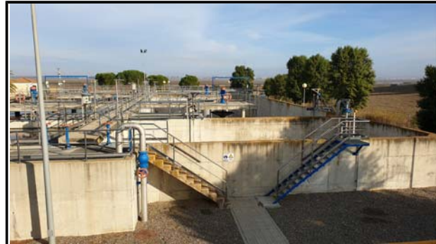
REACTOR BIOLÓGICO. VISTA GENERAL. ZONA ENTRADA (III)
