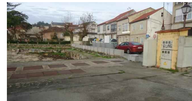
Imagen 6. EBAR Concello. Armario Eléctrico. Detrás Calle Valle Inclán
