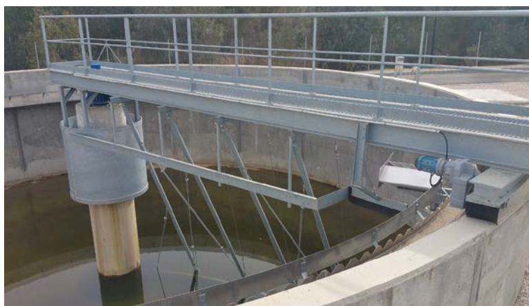
Decantador EDAR Aznalcóllar (Fuente: elaboración propia)
