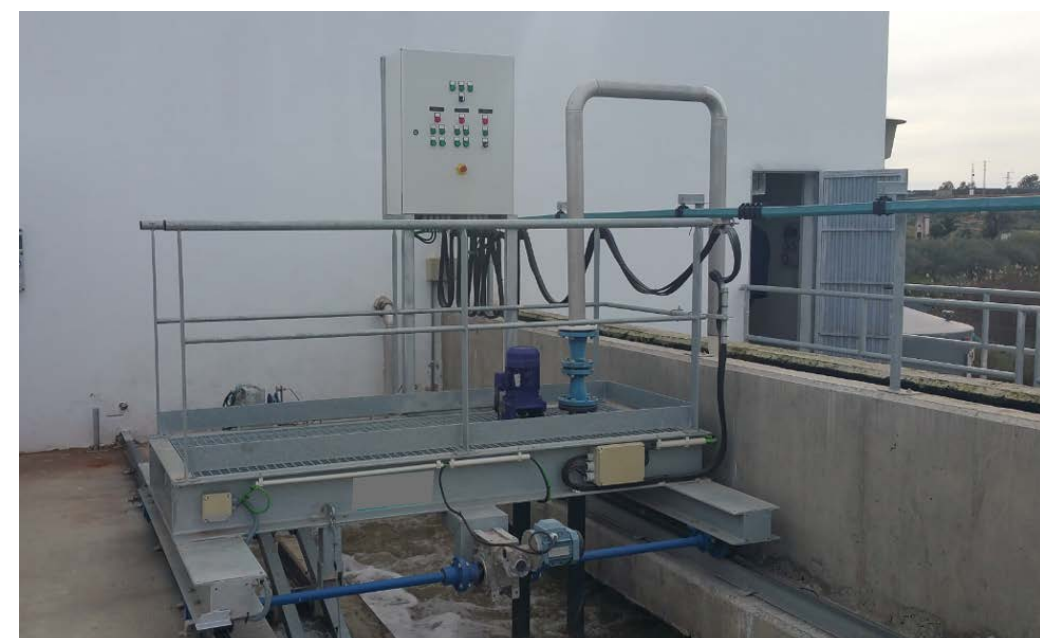
Canal de desarenado EDAR Aznalcóllar (Fuente: elaboración propia)
