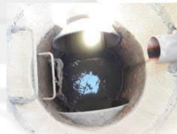
Pozo de registro donde se ubica el caudalímetro
