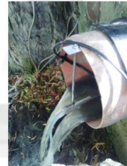
Fotografía del colector con caudalímetro y aspiración de toma de muestra colocada.
