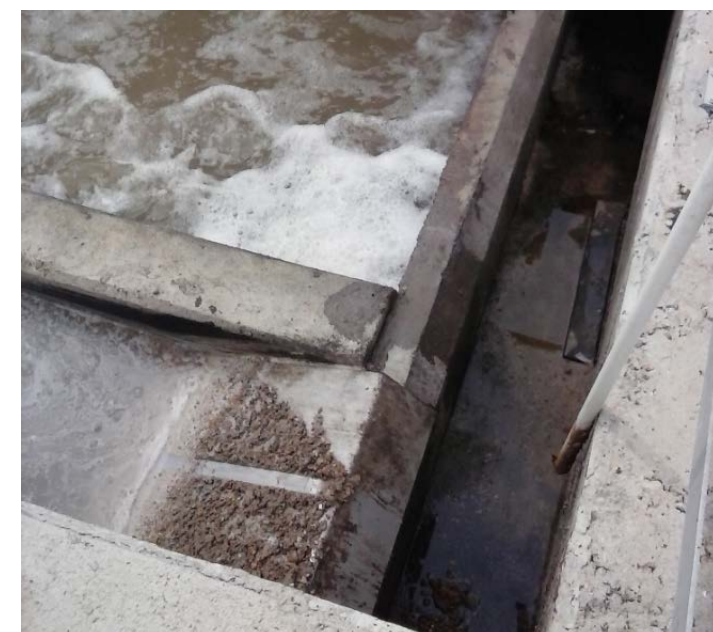
Canal salida de grasas EDAR Aznalcóllar (Fuente: elaboración propia)
