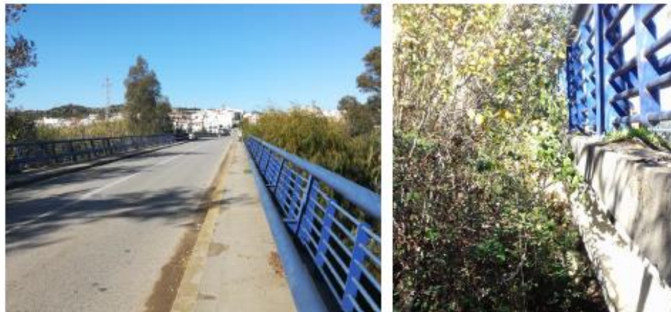
Vista general de puente (izquierda) y detalle del costado aguas abajo (derecha)
