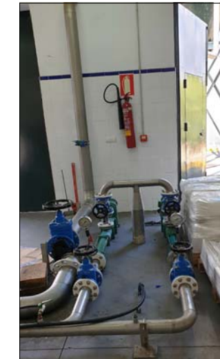
FOTOGRAFÍA 2: BOMBEO DE FANGOS ESPESADOS A DESHIDRATACIÓN
