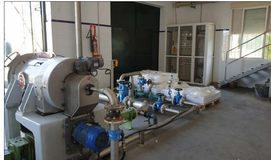
FOTOGRAFÍA 1: CENTRÍFUGA PARA DESHIDRATACIÓN DE FANGOS ESPESADOS
