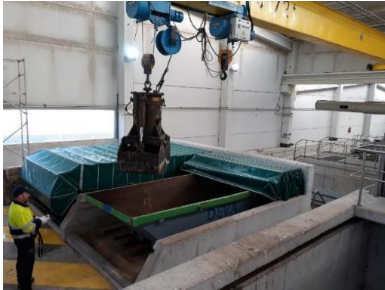
Cubierta retráctil para contenedor de residuos de pozo de gruesos. Maniobra de la cuchara.
