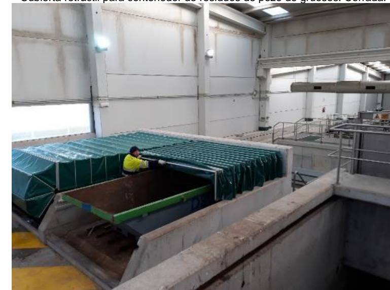
Cubierta retráctil para contenedor de residuos de pozo de gruesos. Abriendo.
