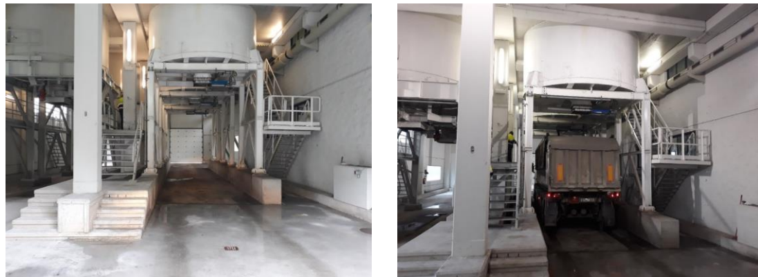
Vista del túnel de descarga de silos y operación de carga de camión
