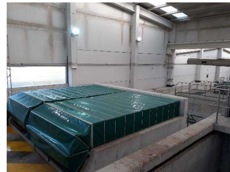
Cubierta retráctil para contenedor de residuos de pozo de gruesos. Cerrada.
