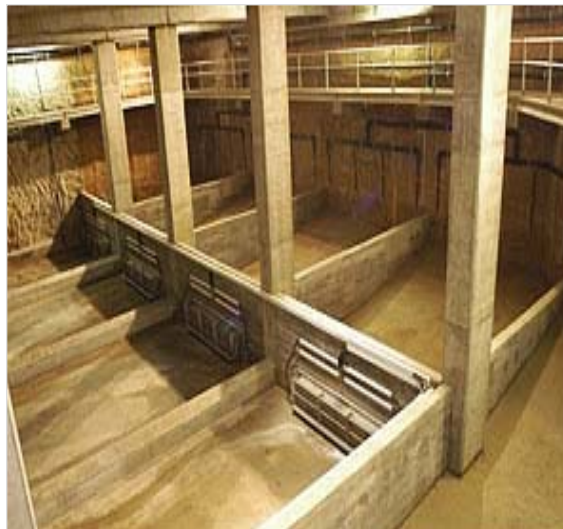
Tanque de tormenta
