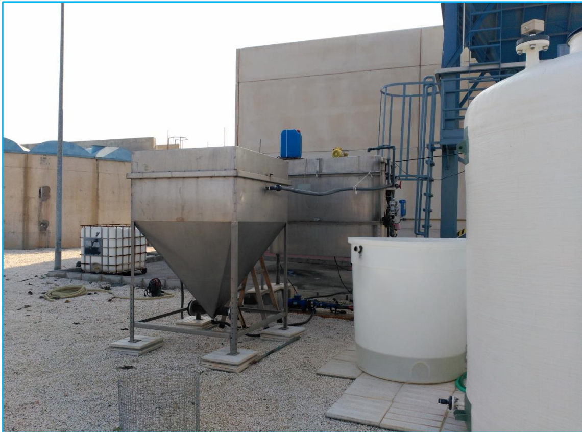
Planta Piloto ubicada en la EDAR de Los Alcázares
