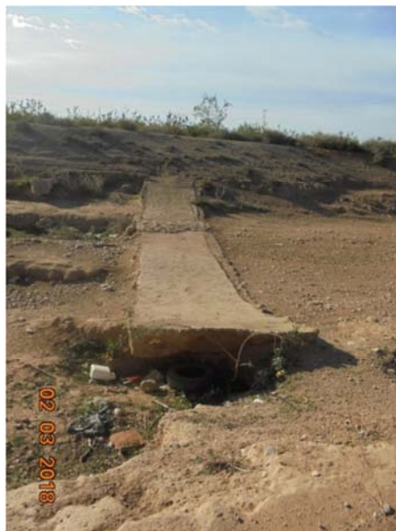
Figura 145: Umbral de fondo en mal estado en la Rambla del Albuñón, en el tramo entre Los Conesas y Albuñón Se puede apreciar la erosión en márgenes y lecho del cauce
