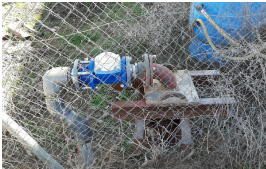
Figura 5.1. Incorrecto. Contador junto a valla de simple torsión doble. Para facilitar el acceso se puede abrir una venta en la malla o dejar la tapa abierta.
