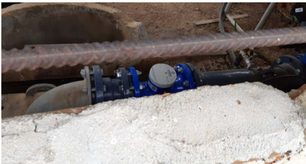
Figura 4.7. Incorrecto. Como desde fuera no se puede levantar la tapa, la misma debe quedar abierta. Ver imagen siguiente.
