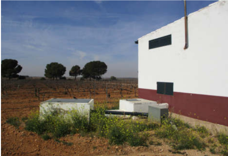
Figura 3.4. Correcto. Pozo dentro de arqueta cerrada (izq.), contador a la derecha, en arqueta abierta. Tubería de conexión visible.
