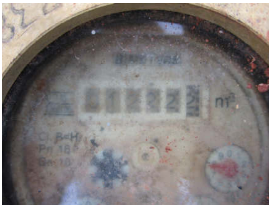
Figura 7.5. Esfera sucia y de difícil lectura. Si la misma está inaccesible dentro de arqueta, no se puede tomar la lectura. Es necesario mantenerla limpia.
