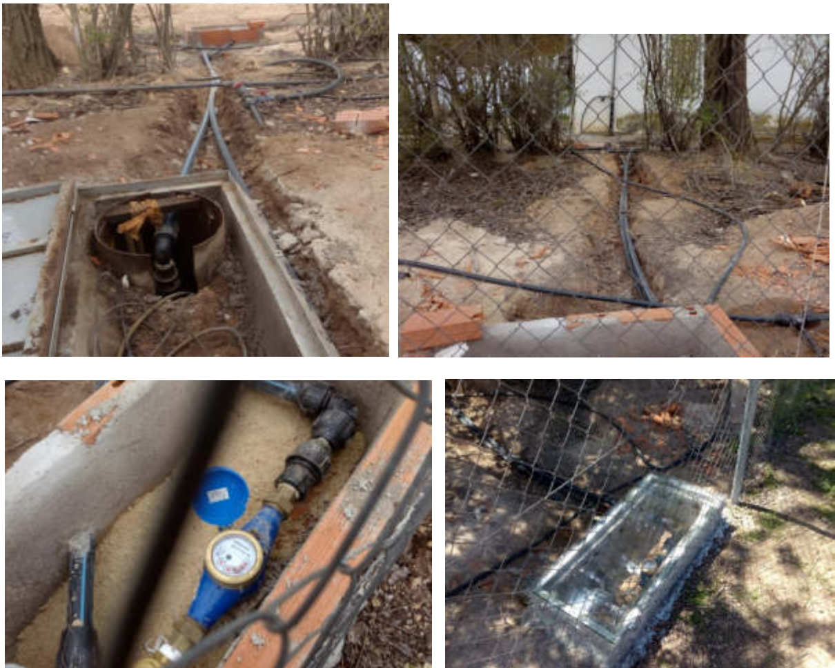
Figura 5.4. Correcto. Contador dentro de vallado. Tubería entre pozo y valla. Hay que asegurarse de que el contador queda instalado en la dirección del flujo. Tapa de policarbonato en arqueta
