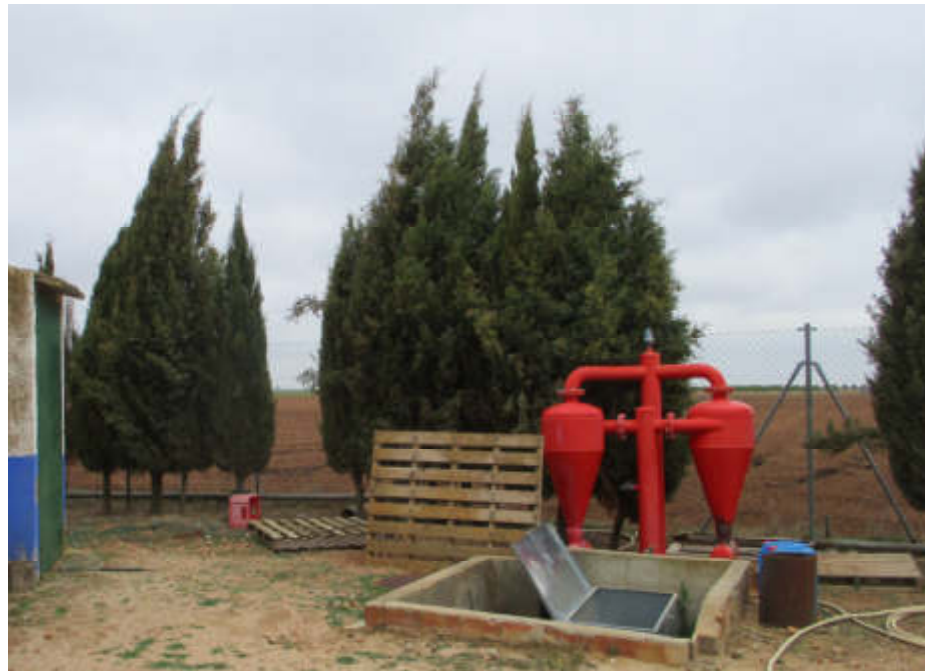
Figura 5.6. Incorrecto. Contador dentro de vallado y en arqueta bajo nivel de suelo. Inaccesible desde el exterior. Se puede sacar mediante tubería o hacer pasillo en la valla perimetral
