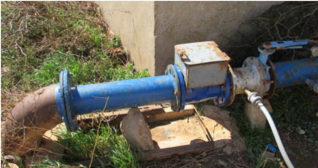
Figura 3.2. Instalación incorrecta. Arqueta que no protege el contador. Tiene el objeto de impedir tomar la lectura e inspeccionar el contador.
