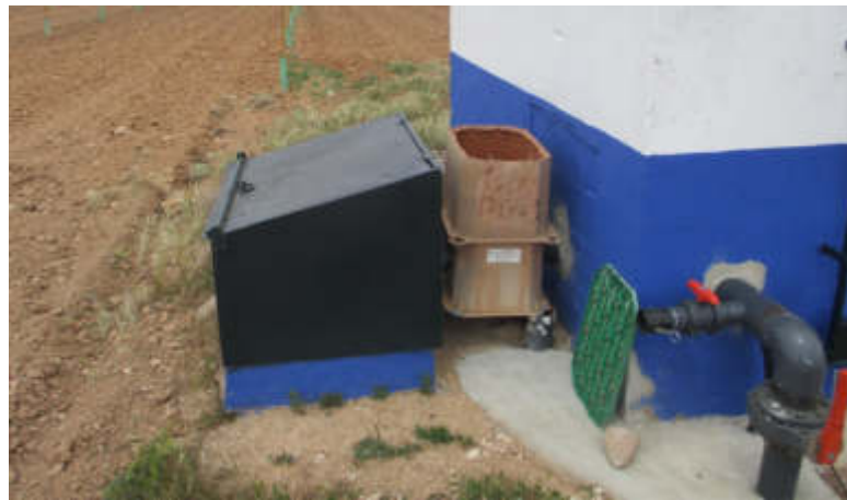
Figura 4.1. Correcto. Captación en arqueta cerrada. Contador en arqueta abierta anexo a caseta de riego. Si es necesario, se puede requerir la presencia del titular para que abra la arqueta del pozo.
