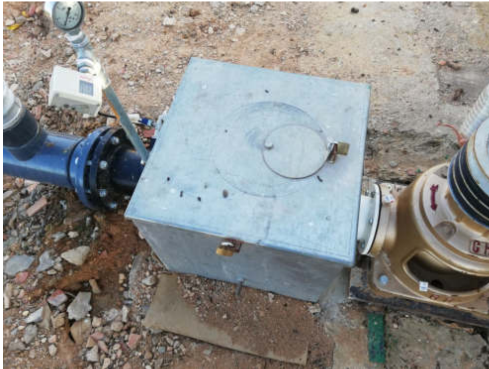
Figura 3.8. Incorrecto. Contador en arqueta cerrada. Visor cerrado con candado.
