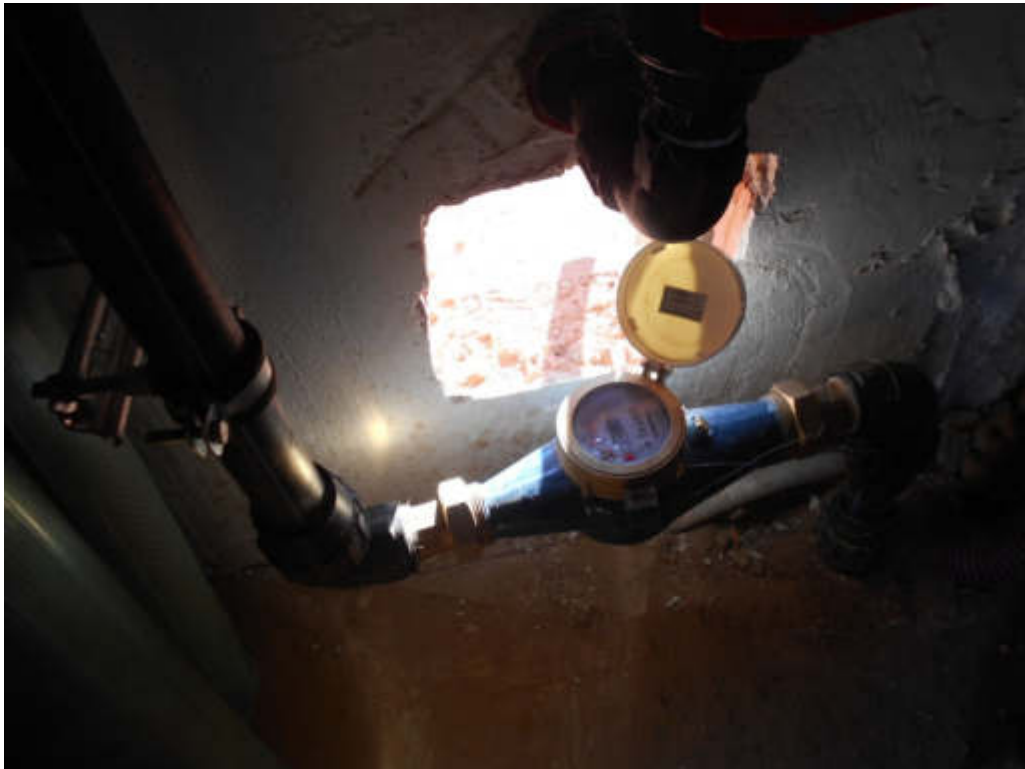
Figura 4.12. Visualización del contador dentro del registro. Tapa levantada. Visto desde el interior de la instalación.
