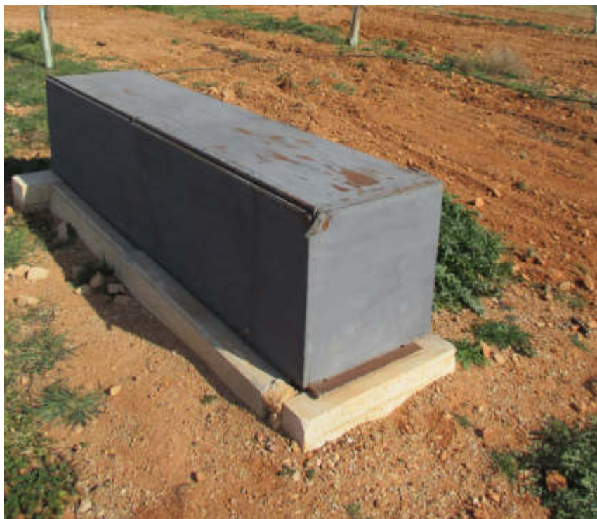
Figura 3.3. Incorrecto. Arqueta cerrada que no permite ver el contador. Un visor en la parte de arriba sería suficiente.
