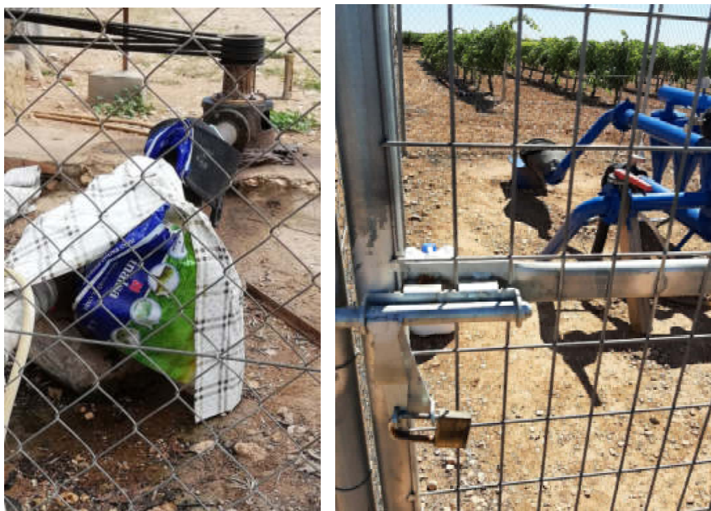
Figura 5.2. Incorrecto. Contador con espuesta encima que impide ver el mismo.
