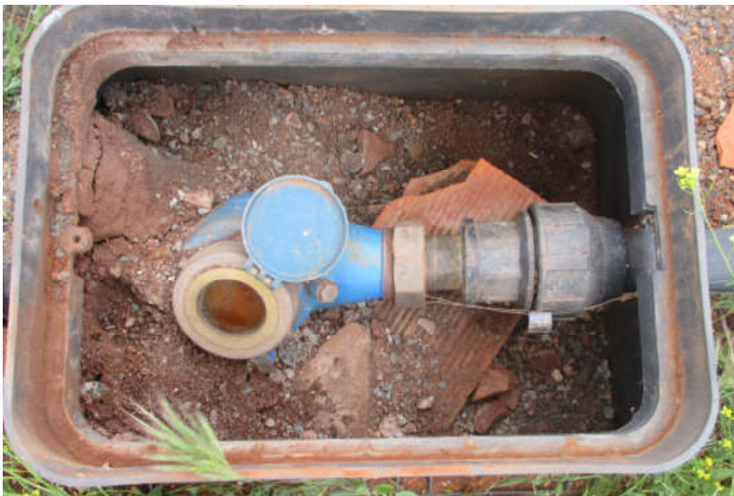
Figura 7.4. Contador en mal estado. Esfera ilegible.
