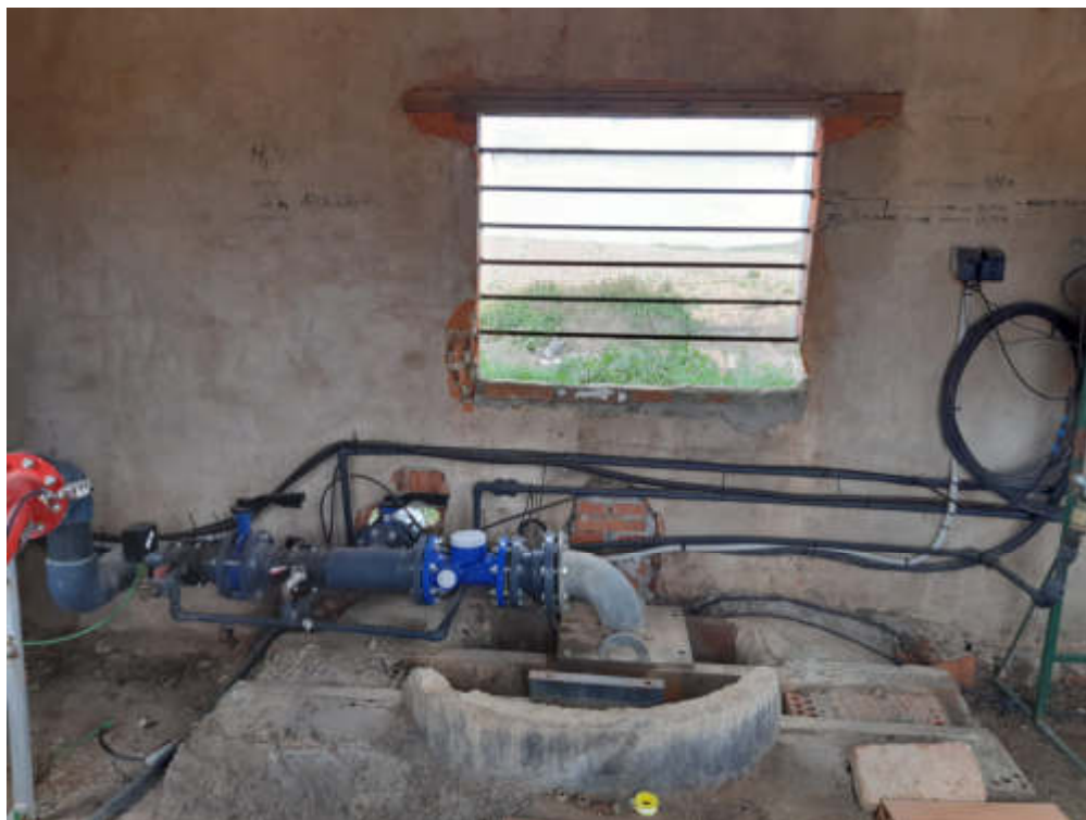
Figura 4.6. Correcto. Ventana que permite ver el contador desde el exterior. Ver imágenes siguientes. Nótese que el contador no es válido para la gestión del DPH.
