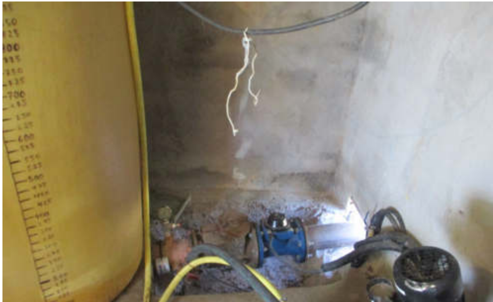
Figura 4.5. Incorrecto. Contador en el interior de caseta, existiendo tubo pasante. El contador puede quedar en el exterior.
