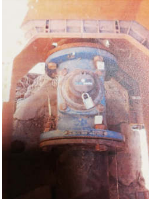
Figura 7.1. Contador inaccesible. Candado en la propia tapa del totalizador.
