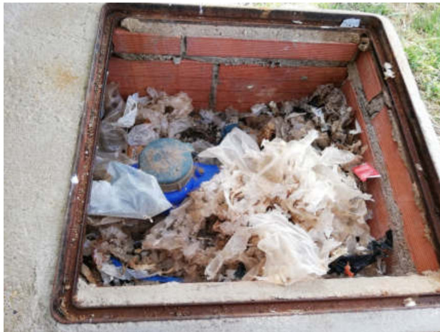
Figura 2.1. Contador en arqueta con nido de ratones. Estado tras retirar parte de la suciedad
