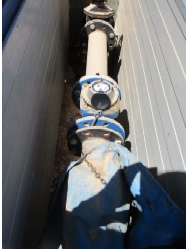
Figura 7.3. Trapos, sacos y demás, que no deben cubrir el contador dentro de la arqueta que impida ver a través del visor.
