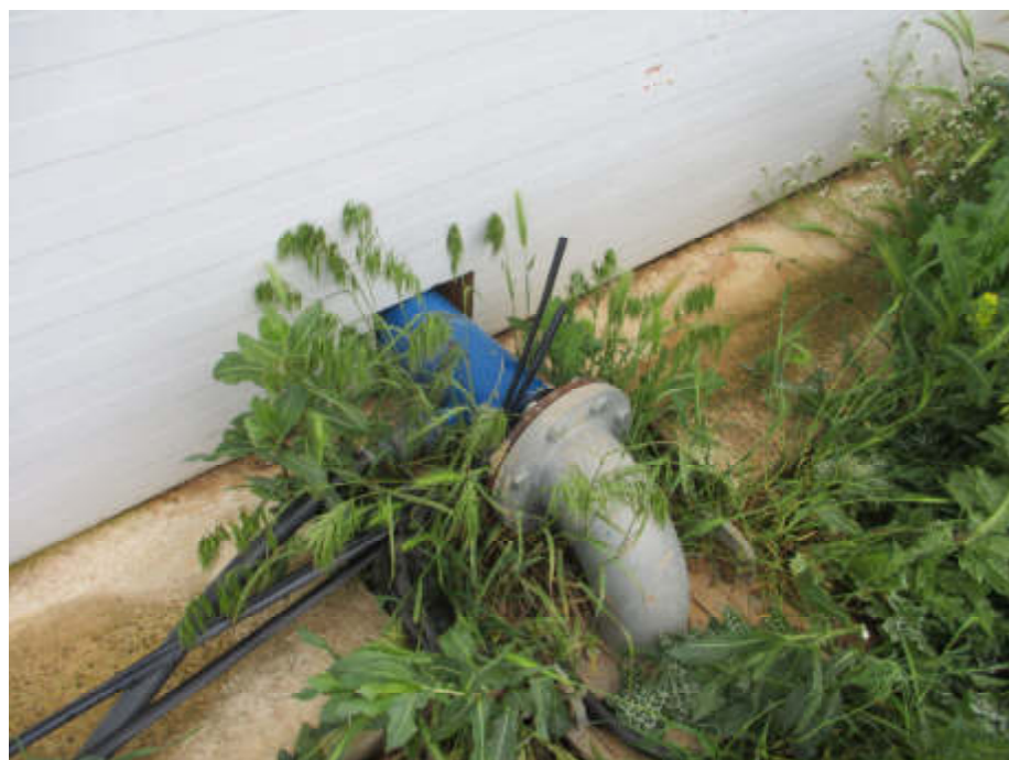
Figura 4.4. Incorrecto. Tubo pasante, el contador se puede situar en el exterior. Máxime cuando la captación está fuera de caseta.
