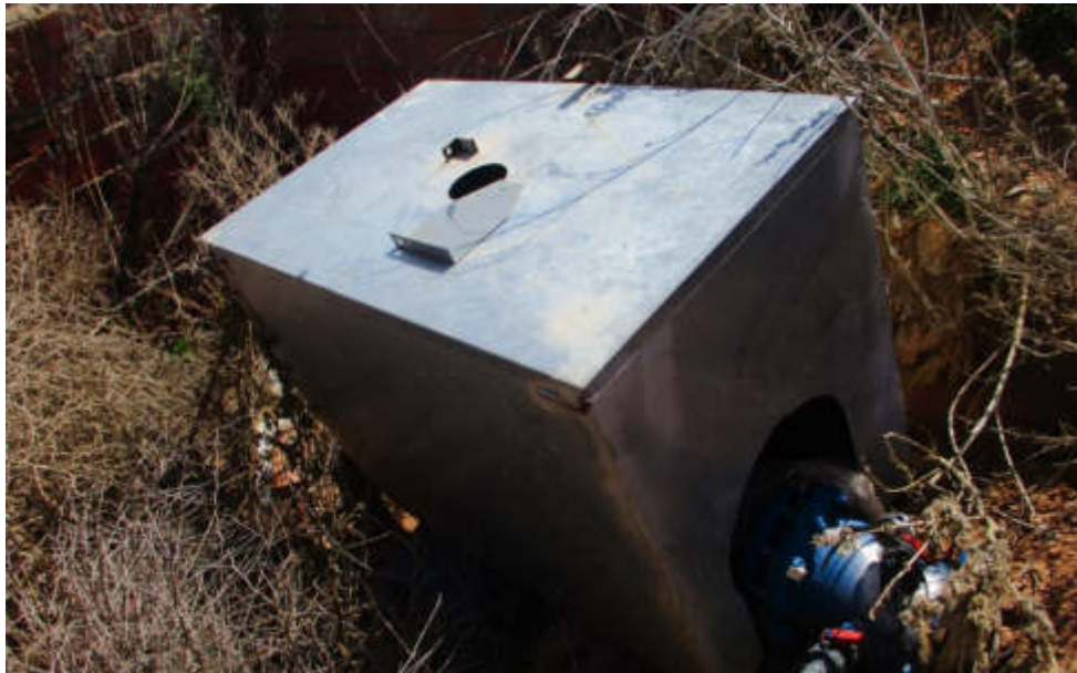
Figura 3.6. Correcto. Arqueta con visor. Hay que comprobar que el tamaño y ubicación es el adecuado para poder realizar las comprobaciones oportunas.
