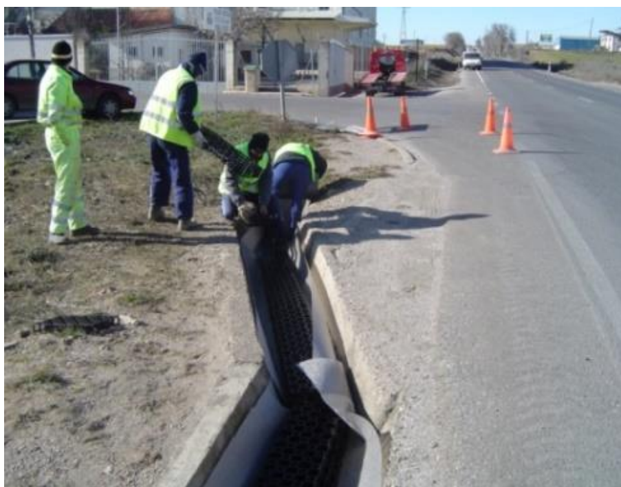
Ecocuneta reducida constituida con celdas drenantes de 52 mm envueltas en geotextil y cubiertas con gravilla. Medina de Ríoseco (Valladolid). Cortesía de «SUDS S.L - Atlantis».
