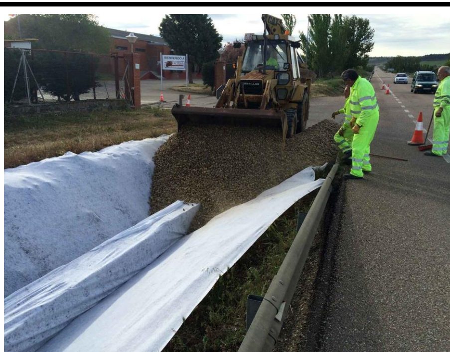
Ecocuneta constituida con cajas drenantes envueltas en geotextil. Medina de Ríoseco (Valladolid). Cortesía de «SUDS S.L - Atlantis».
