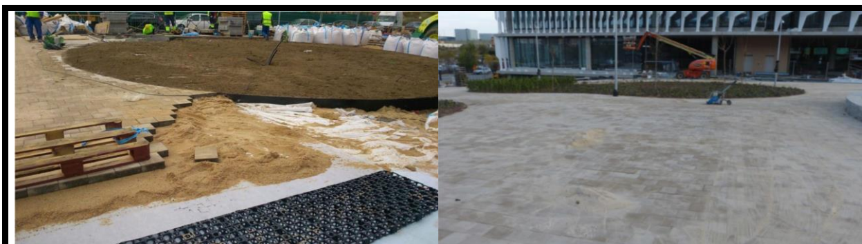
Pavimento permeable. Nueva Sede BBVA en el Barrio de Las Tablas Madrid (Fase I y Fase II). Años 2013-2015. Cortesía de «SUDS S.L - Atlantis».
