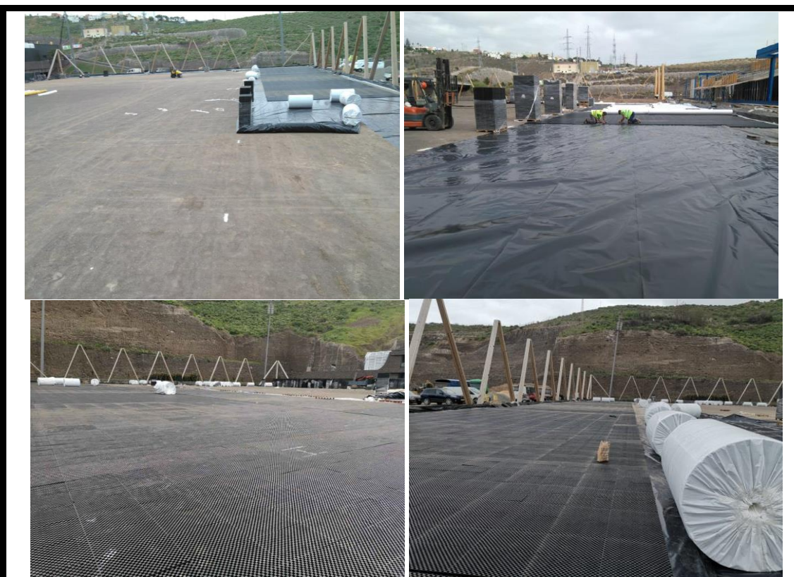
Drenaje horizontal en el nuevo complejo de la ciudad deportiva de la Unión Deportiva Las Palmas (España). Se utilizaron celdas drenantes de 30 mm bajo uno de los terrenos deportivos para la captación y canalización de las aguas pluviales, y depósitos modulares perimetrales para su acumulación y posterior reciclado. Años 2016-2017. Cortesía de «SUDS S.L - Atlantis».
