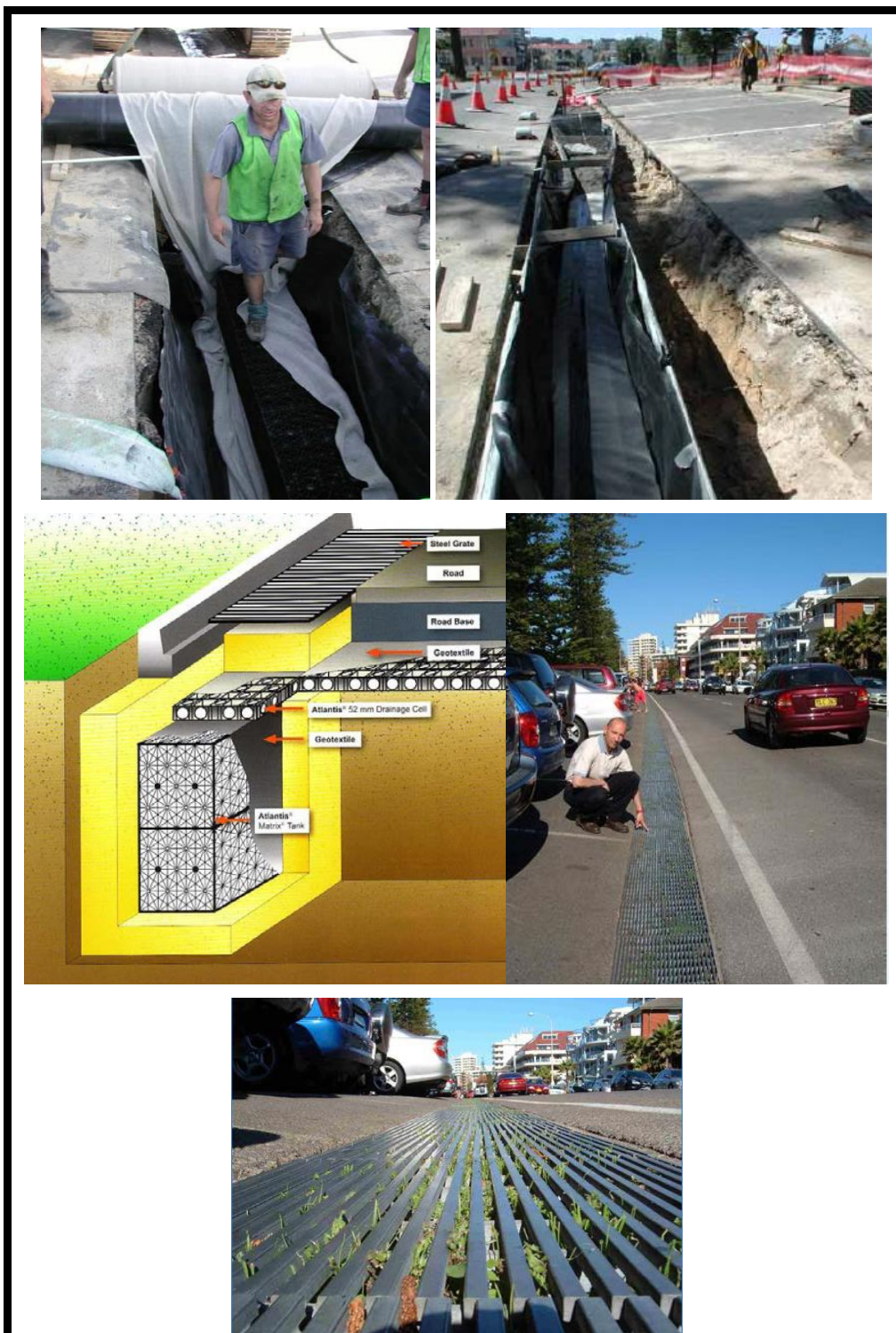
Debajo de la rejilla se localiza el Sumidero filtrante compuesto por cajas drenantes, que llevan el agua filtrada a un depósito permeable localizado en la playa donde el agua pluvial de escorrentía se infiltra. Australia. Cortesía de «SUDS S.L - Atlantis».
