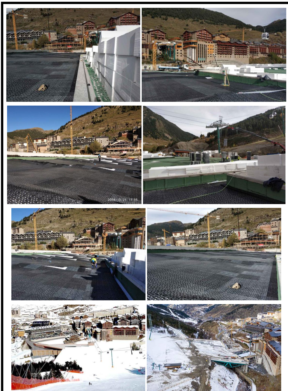
Drenaje horizontal. Plataforma esquiable de Soldeu (Andorra). Se utilizaron celdas drenantes de 52 mm para proteger la impermeabilización de la estructura y evacuar subsuperficialmente el agua de la nieve/lluvia. Año 2018. Cortesía de «SUDS S.L - Atlantis».
