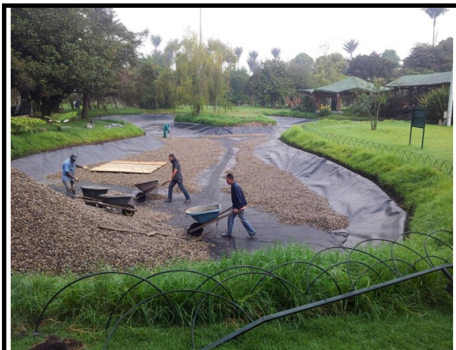
Humedal. Jardín Botánico de Bogotá José Celestino Mutis. Existían problemas de fugas en el humedal, se utilizó una geomembrana, celdas drenantes y cajas, y se relleno con grava, creando montículos para una recirculación natural del agua. Cortesía de «SUDS S.L - Atlantis».
