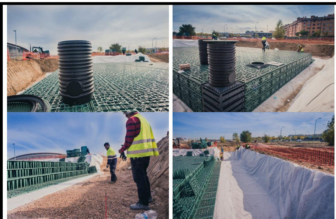
El agua previamente filtrada en los SUDS puede ser almacenada en depósitos. Depósitos de infiltración de 200 m 3 , 100 m 3 y 55 m 3 de capacidad, equipados con 1.857 bloques Ecobloc Light, Arquetas Vario 800 Flex y cubierta peatonal. Parque Olímpico de Madrid - Estadio Wanda Metropolitano. Noviembre de 2018. Cortesía de GRAF Iberica.
