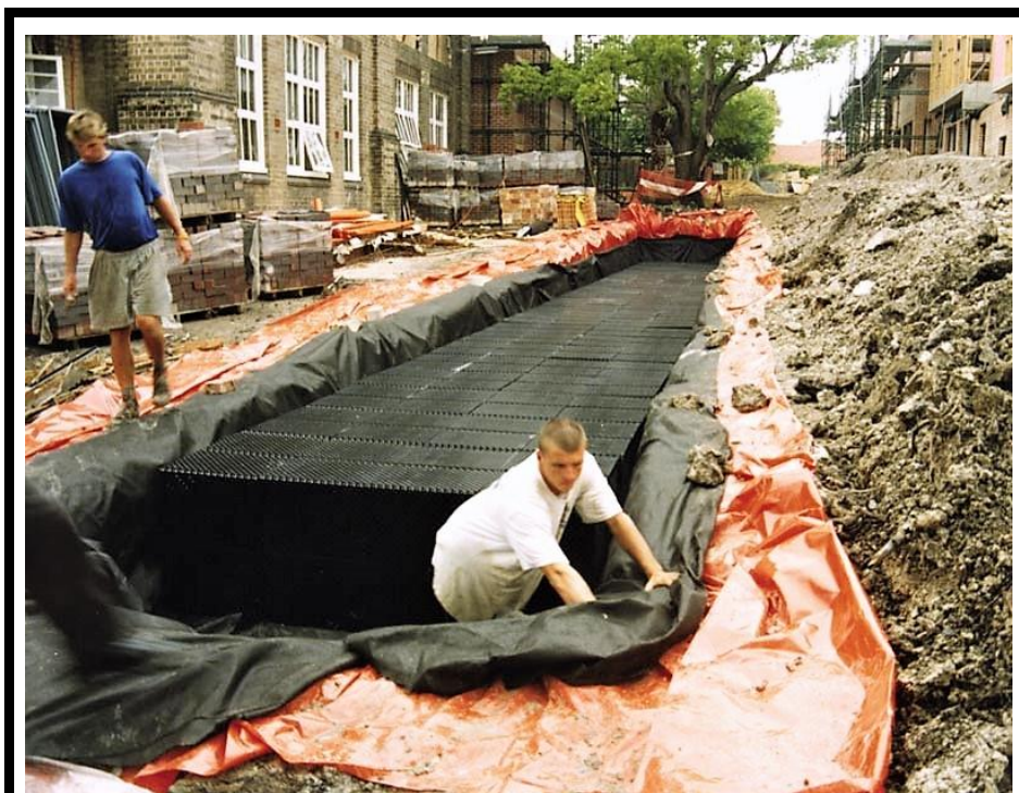
El agua previamente filtrada en los SUDS puede ser almacenada en depósitos. Depósito modular impermeable constituido con cajas drenantes de 450 mm y envuelto en geomembrana. Cortesía de «SUDS S.L. Atlantis».
