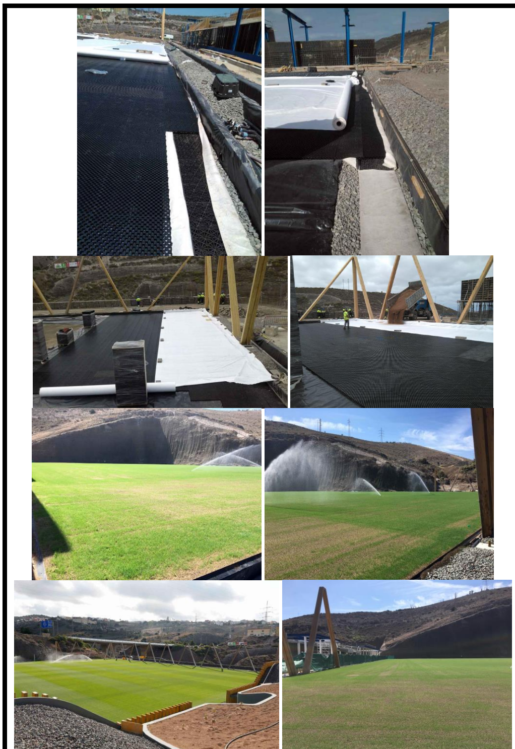
Drenaje horizontal en el nuevo complejo de la ciudad deportiva de la Unión Deportiva Las Palmas (España). Se utilizaron celdas drenantes de 30 mm bajo uno de los terrenos deportivos para la captación y canalización de las aguas pluviales, y depósitos modulares perimetrales para su acumulación y posterior reciclado. Años 2016-2017. Cortesía de «SUDS S.L - Atlantis».
