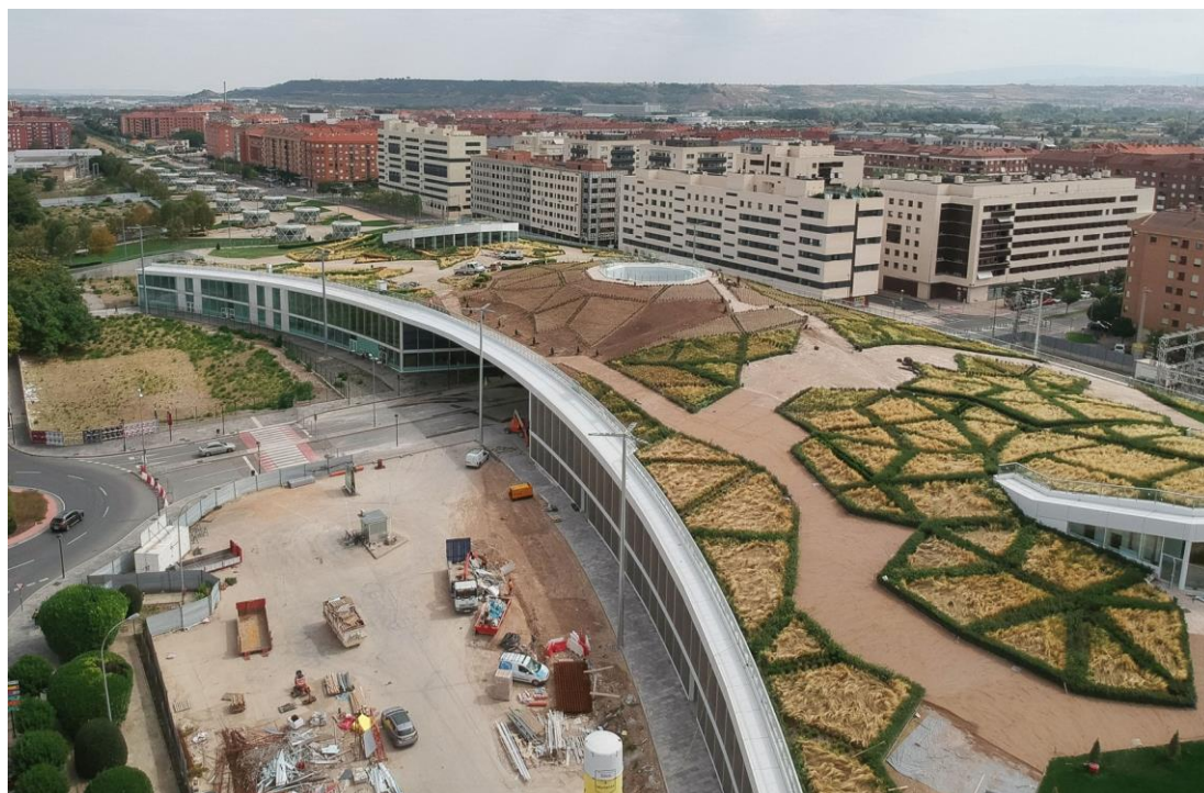
Cubierta ecológica que crea lugares estanciales y de convivencia. Estación de Ferrocarril y Autobuses de Logroño (España). Años 2012-2013. Cortesía de «SUDS S.L - Atlantis».
