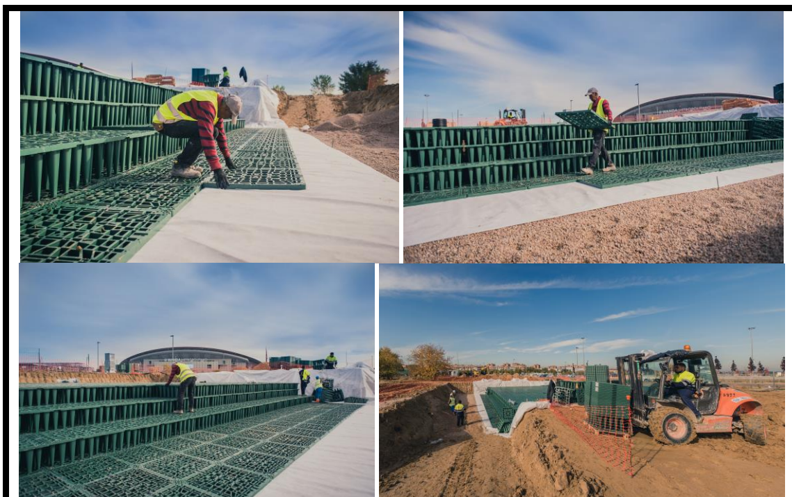
El agua previamente filtrada en los SUDS puede ser almacenada en depósitos. Depósitos de infiltración de 200 m 3 , 100 m 3 y 55 m 3 de capacidad, equipados con 1.857 bloques Ecobloc Light, Arquetas Vario 800 Flex y cubierta peatonal. Parque Olímpico de Madrid - Estadio Wanda Metropolitano. Noviembre de 2018. Cortesía de GRAF Iberica.
