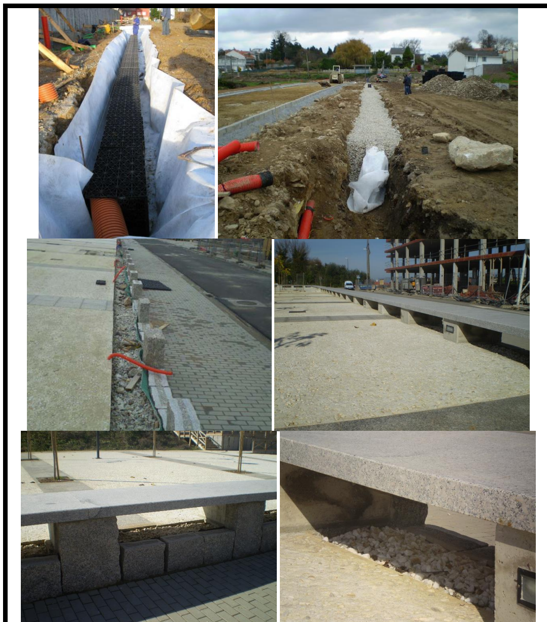
Sumidero filtrante. Urbanización en Meixonfrio, Oleiros (A Coruña). Sumidero filtrante debajo de bancos. Años 2007-2008. Cortesía de «SUDS S.L - Atlantis».
