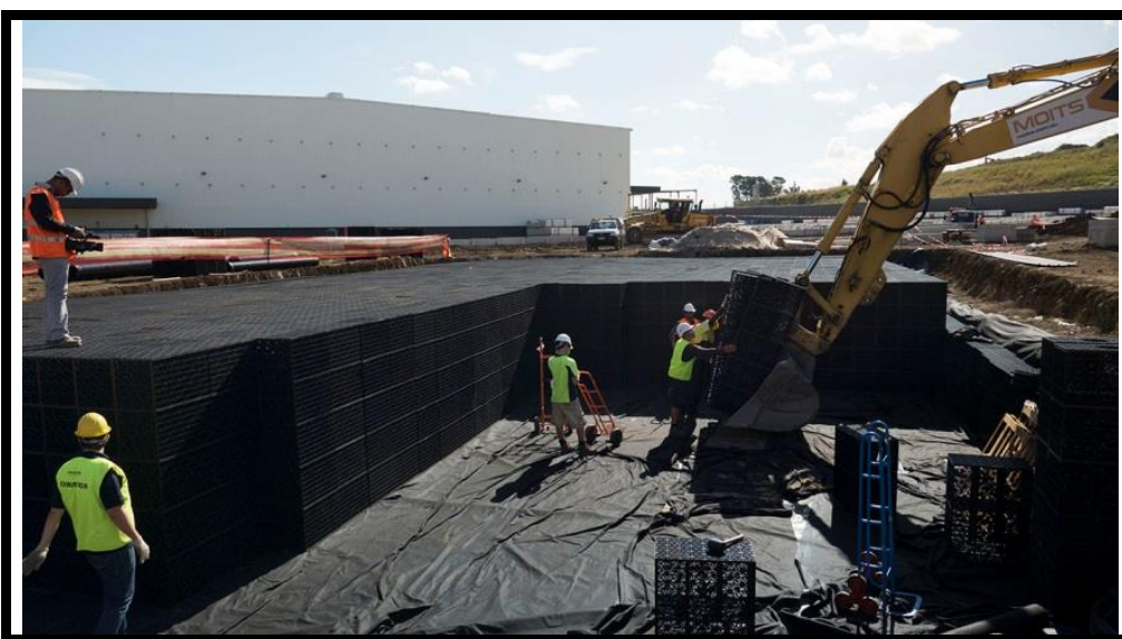
El agua previamente filtrada en los SUDS puede ser almacenada en depósitos. Depósito modular permeable constituido con cajas drenantes envueltas en geotextil. Cortesía de «SUDS S.L - Atlantis».
