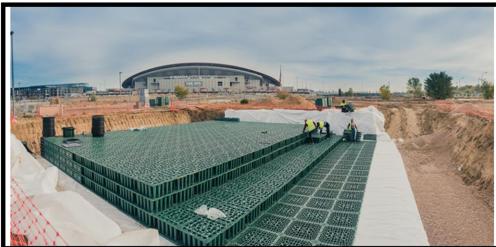
El agua previamente filtrada en los SUDS puede ser almacenada en depósitos. Depósito de infiltración. Parque Olímpico de Madrid - Estadio Wanda Metropolitano. Noviembre de 2018. Cortesía de GRAF Iberica.
