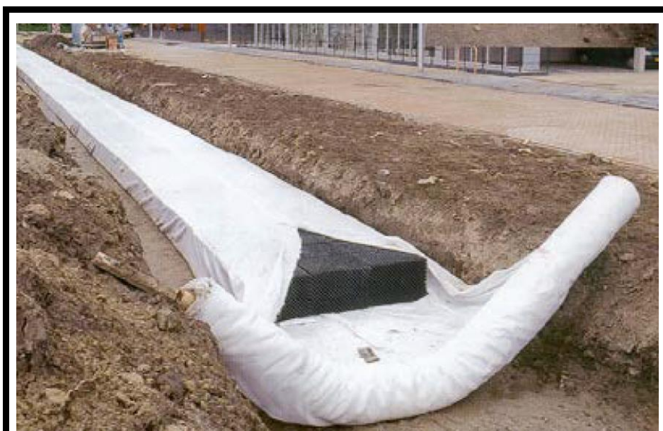
El agua previamente filtrada en los SUDS puede ser almacenada en depósitos. Depósito modular permeable construido con cajas drenantes Atlantis y envuelto en geotextil. Cortesía de «SUDS S.L. - Atlantis».
