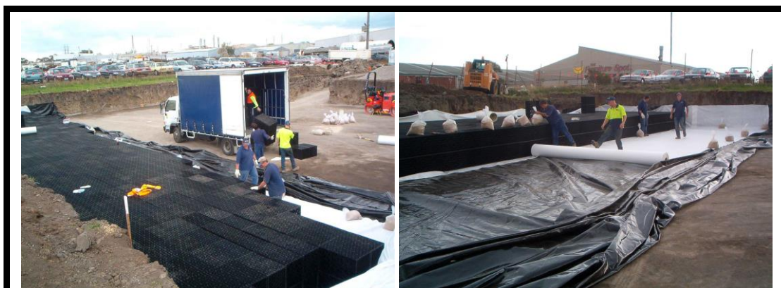
El agua previamente filtrada en los SUDS puede ser almacenada en depósitos. Depósito modular impermeable constituido con cajas drenantes de 450 mm y envuelto en geomembrana. Cortesía de «SUDS S.L. Atlantis».
