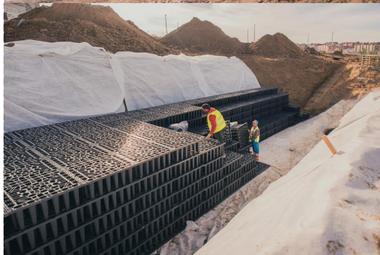
El agua previamente filtrada en los SUDS puede ser almacenada en depósitos. Depósito de infiltración de 145 m 3 de capacidad, equipado con 624 bloques Ecobloc Maxx, Arquetas Vario 800 Flex y cubierta peatonal. Parque Olímpico de Madrid - Estadio Wanda Metropolitano. Noviembre de 2018. Cortesía de GRAF Iberica.
