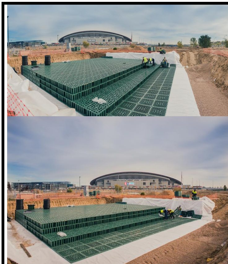
El agua previamente filtrada en los SUDS puede ser almacenada en depósitos. Depósitos de infiltración de 200 m 3 , 100 m 3 y 55 m 3 de capacidad, equipados con 1.857 bloques Ecobloc Light, Arquetas Vario 800 Flex y cubierta peatonal. Parque Olímpico de Madrid - Estadio Wanda Metropolitano. Noviembre de 2018. Cortesía de GRAF Iberica.
