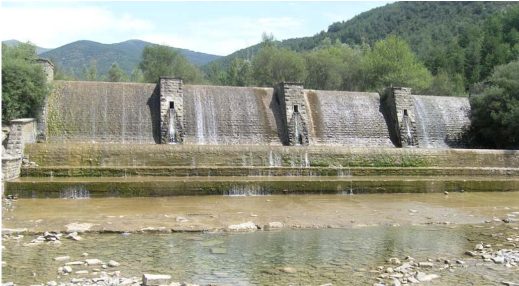
Foto 48: Presa de sedimentos colmatada de Isín, en el río Aurín (A.Ollero)
