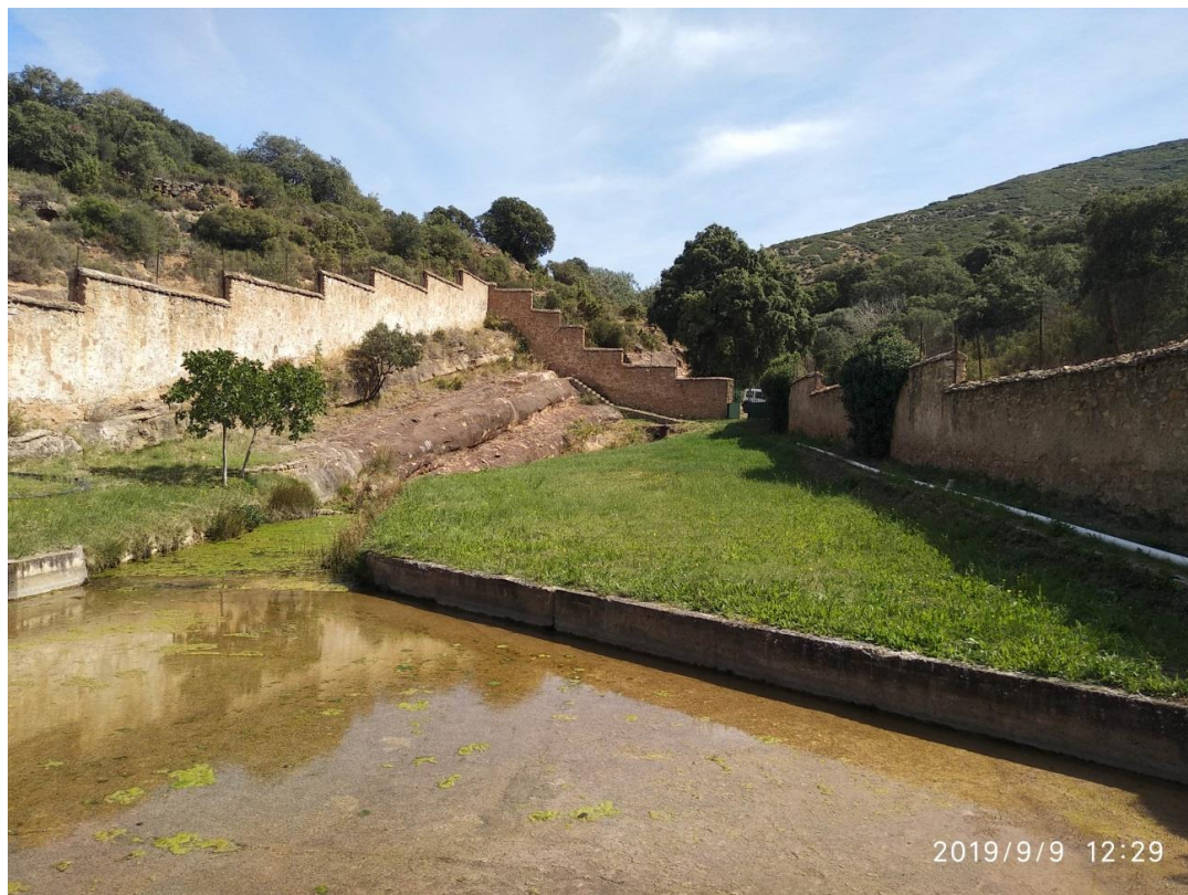
Interior del recinto de protección
