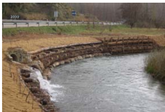
Talud restaurado mediante empalizada de defensa reforzada, cubrimiento orgánico, rollo estructurado y estaquillado del talud.
