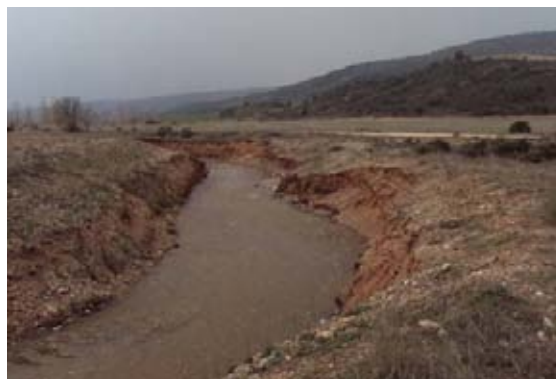
Estado del talud con dinámica erosiva.
