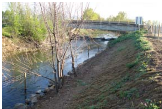
Talud restaurado con la colocación de una geomalla fijada con estaquillas de sauce y protegido con una fajina de empalizada trenzada con escollera.
