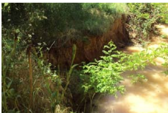
Situación previa en el talud del área de descanso.
