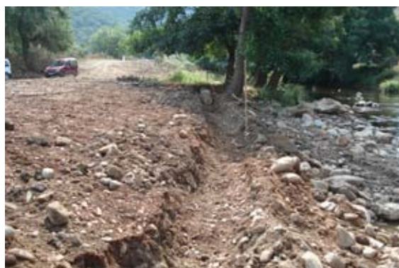
Trabajos para la colocación de cubrimiento orgánico y protección vegetal para controlar la erosión.
