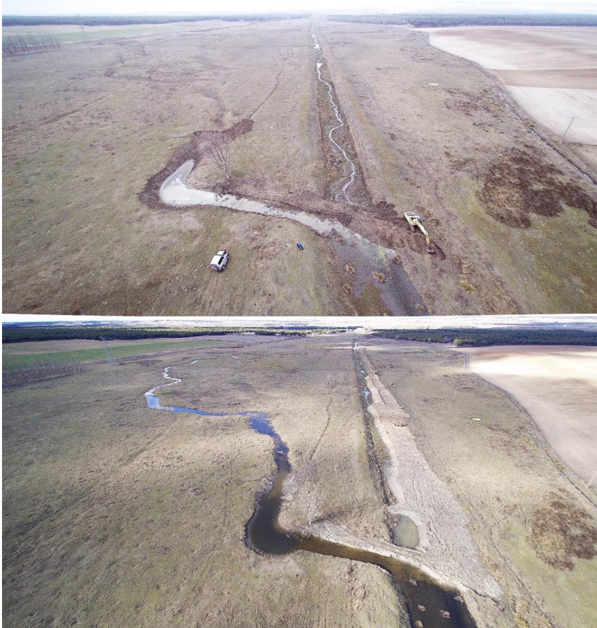
Fotografía 8. Actuación de recuperación del trazado natural en un tramo rectificado del río Zapardiel. Inicio de las obras (arriba) y conexión del trazado antiguo tras las obras (abajo).
