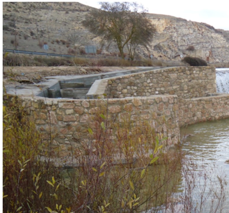
Escala de peces en el azud de la Güera para mejorar la conectividad longitudinal del río.
