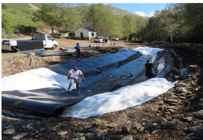
Imagen 3: Demolición de antigua piscifactoría y construcción de charca artificial en la RNF Rego da Ribeira Grande.
