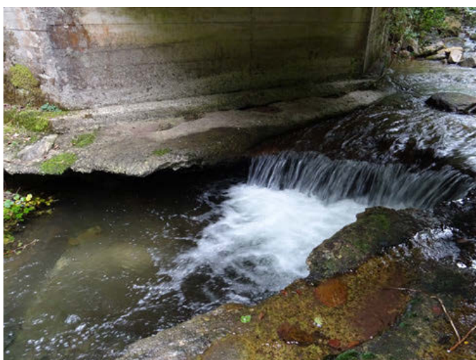
Foto 5: Puente con losa de hormigón en mal estado
