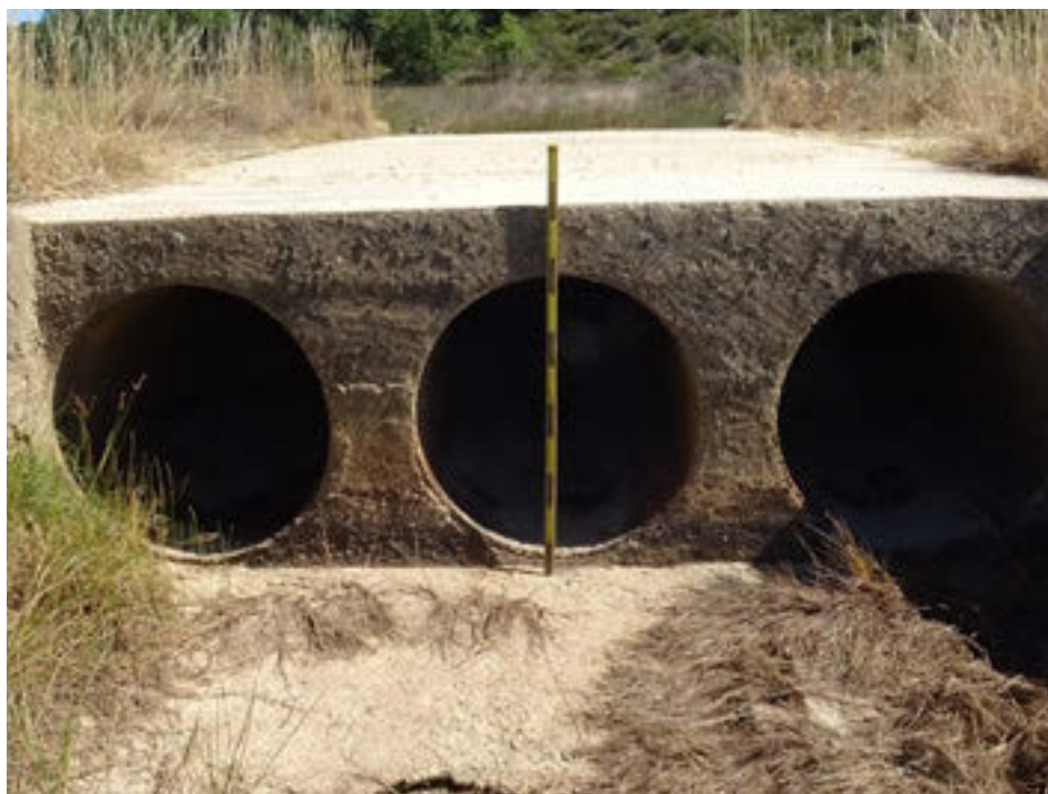
Foto 12: Paso entubado en la zona 6
