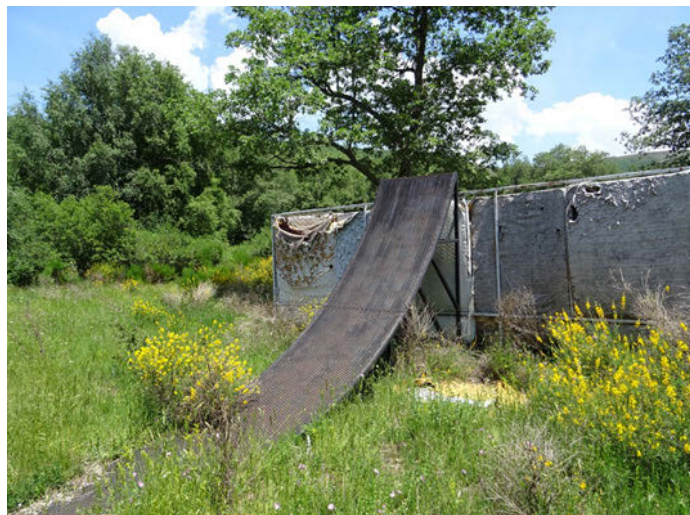
Foto 8: Residuos en el cauce
