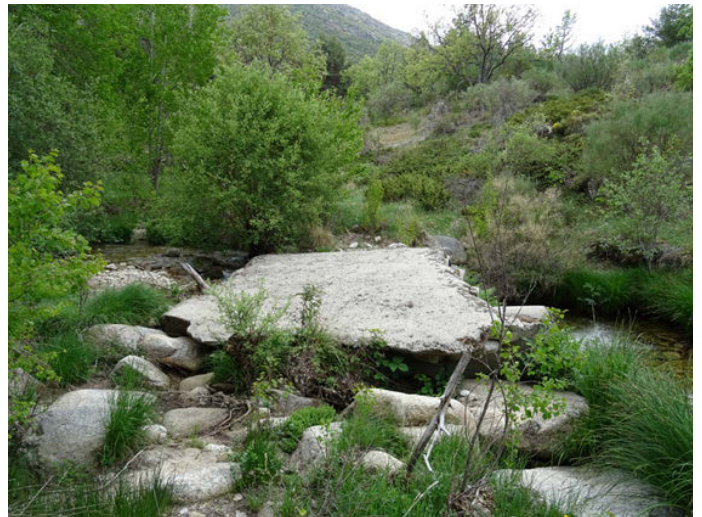
Foto 4: Paso entubado derruido del Puente de la Ramona.
