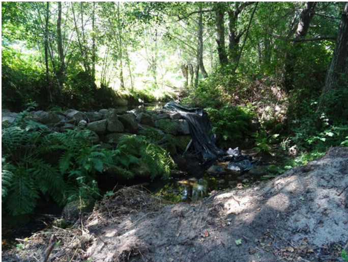
Foto 7. Segundo azud de gran tamaño totalmente colmatado en parte media de la zona 3
