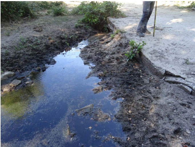
Foto 21. Paso con paramento con un pequeño paso entubado colmatado
