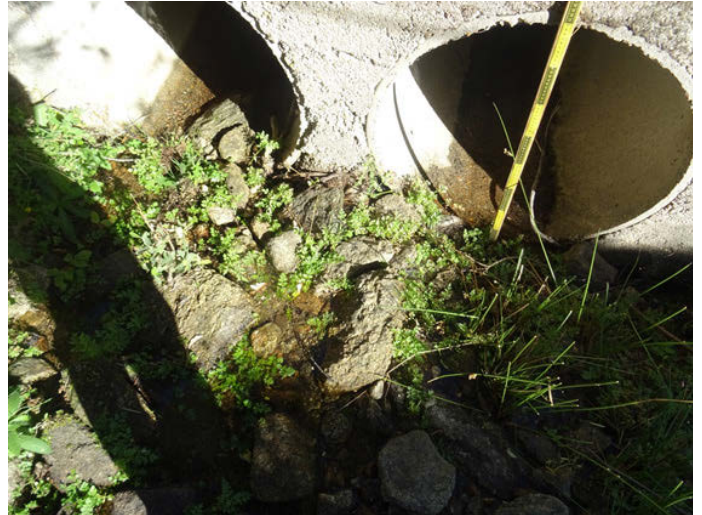
Foto 20. Paso entubado en la parte alta de la reserva, zona 2
