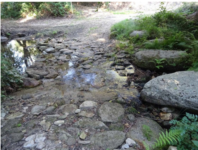
Foto 5. Vado construido con bloques del propio río cementados aguas abajo del segundo gran azud
