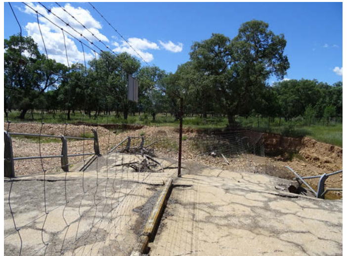
Foto 16. Antiguo puente en ruinas en la finca de El Molinillo, ocupando la mitad del cauce
