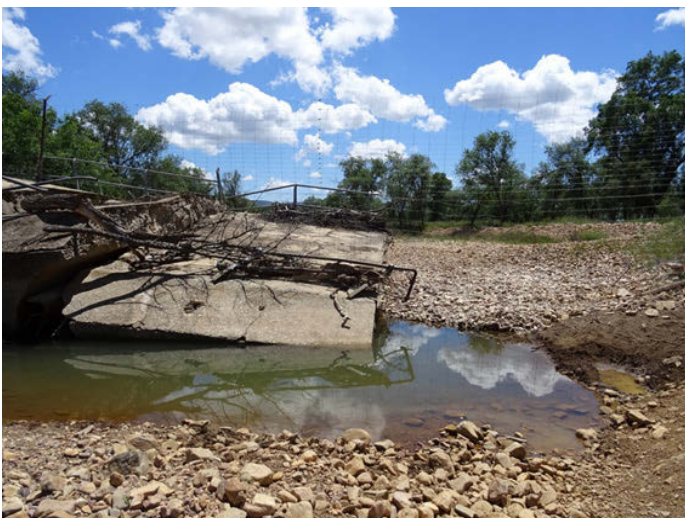
Foto 17. Puente en ruinas en la finca de El Molinillo
