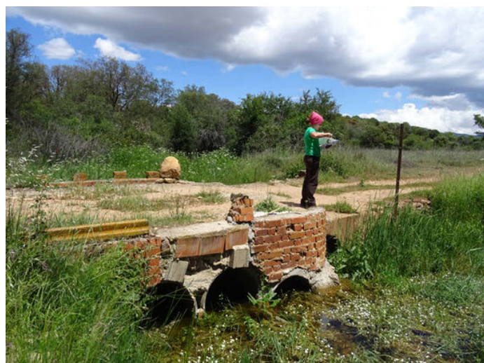
Foto 45: Vado en mal estado de conservación situado a 250 m aguas abajo del puente de Las Gamas
