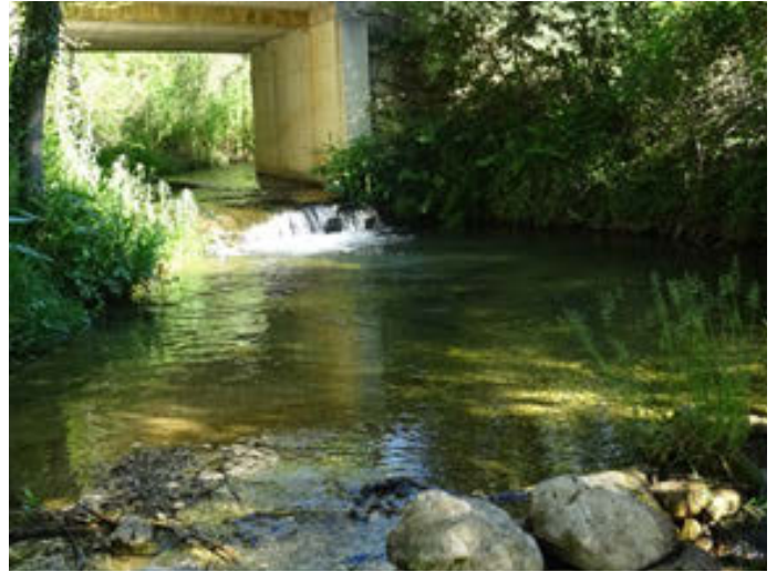
Foto 15. Descalce del puente y posterior azud de piedras en el Arroyo de la Sierra
