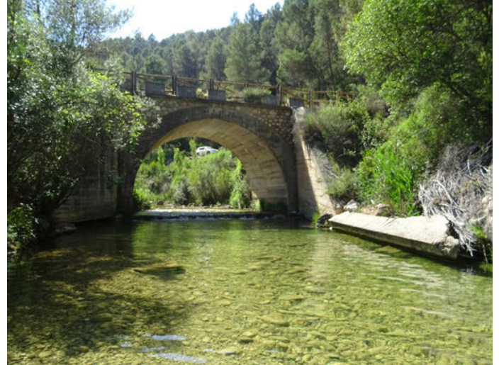
Foto 7. Descalce del puente y estructura hormigonada en el cauce de la RNF del Río Tus
