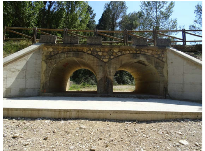
Foto 9. Puente con un salto vertical originado por la solera de la estructura
