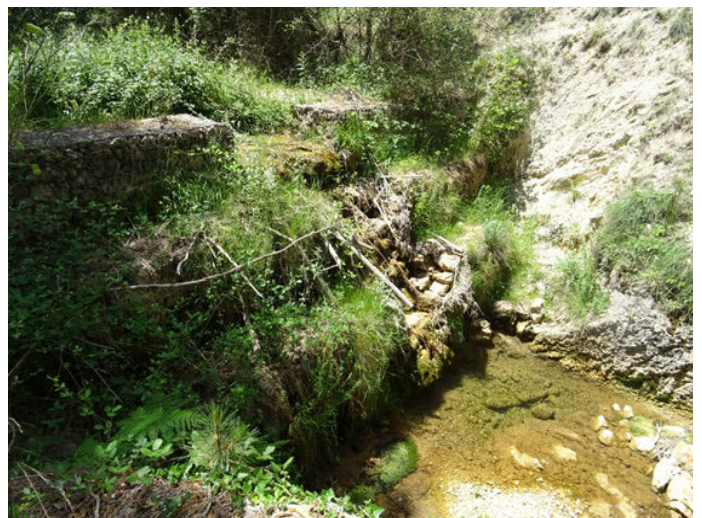
Foto 6. Dique de corrección hidrológico-forestal en el Arroyo de la Fuente del Tejo
