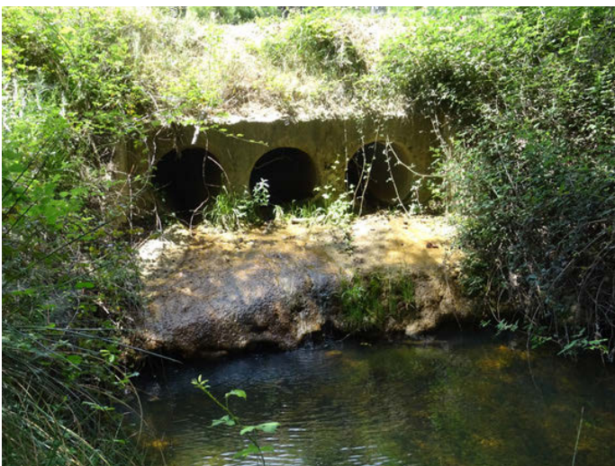
Foto 5. Paso entubado y descalce de la estructura en la cabecera del A. Fuente del Tejo
