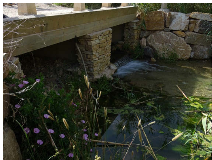
Foto 10. Pequeño descalce por la losa de hormigón en un puente de la RNF del Río Chícamo
