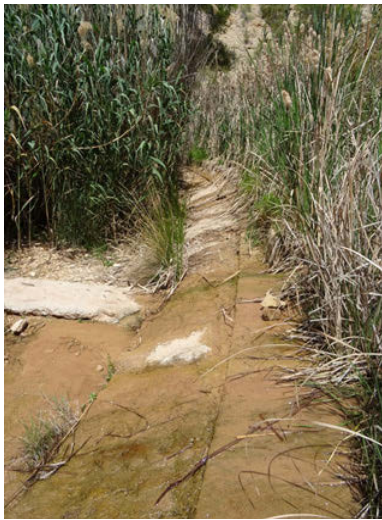
Foto 14. Azud colmatado tras la salida del Cañón del Cagel en la RNF del Río Chícamo
