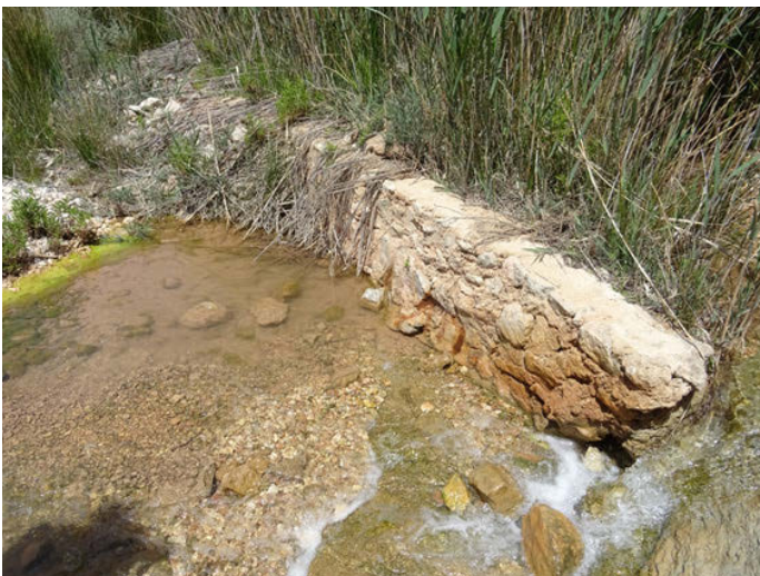
Foto 16. Azud colmatado, colonizado por vegetación y roto en el tramo medio de la RNF
