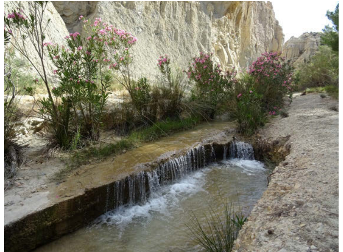
Foto 22. Salto vertical ocasionado por la estructura de hormigón que soterra la conducción
