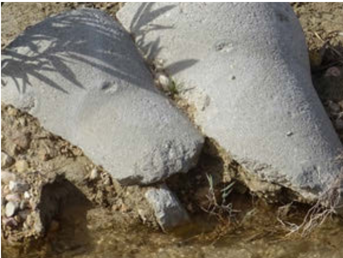
Foto 21. Restos de estructuras de hormigón en el cauce de la RNF del Chícamo
