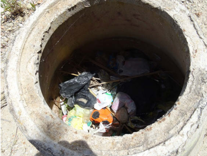
Foto 17. Deposición de basura en antiguas infraestructuras de la central hidroeléctrica
