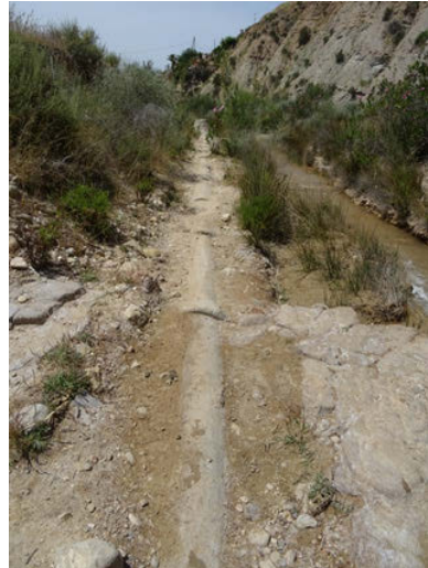
Foto 18. Conducción de la antigua central hidroeléctrica del Chícamo a lo largo del cauce
