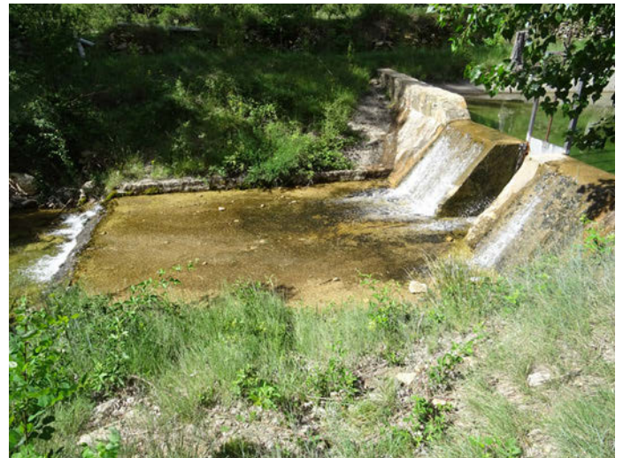
Foto 10. Contradique del Azud de compuerta de piedras, con código 661 Inventario azudes CHJ.
