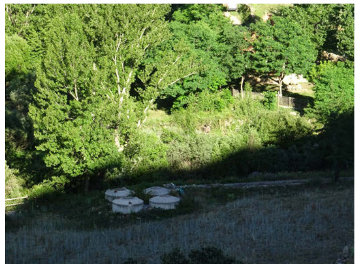
Foto 12. Tanques de almacenamiento de las aguas residuales de la localidad de Linares de Mora.
