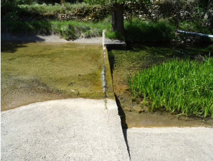
Foto 7. Obstrucción aguas arriba del Azud de compuerta en la ermita de Loreto de Linares de Mora
