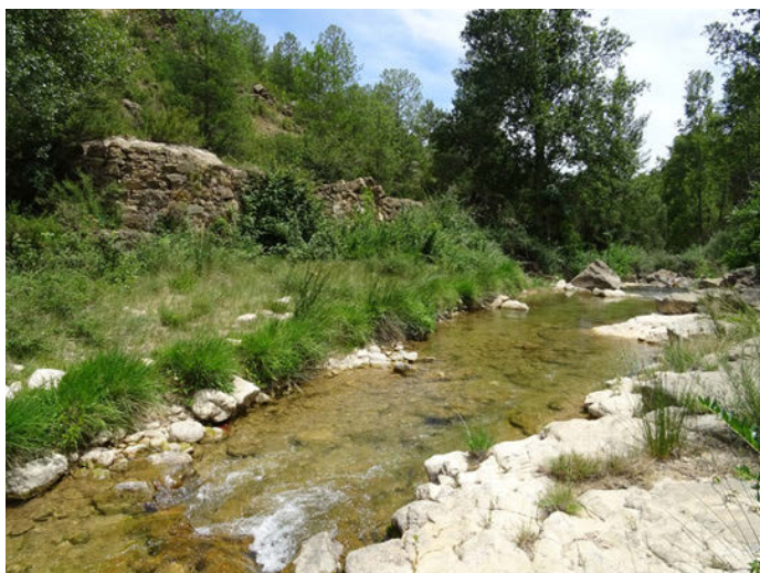
Foto 27. Antigua estructura de conducción del agua para la Central Hidroeléctrica de Puertomingalvo.
