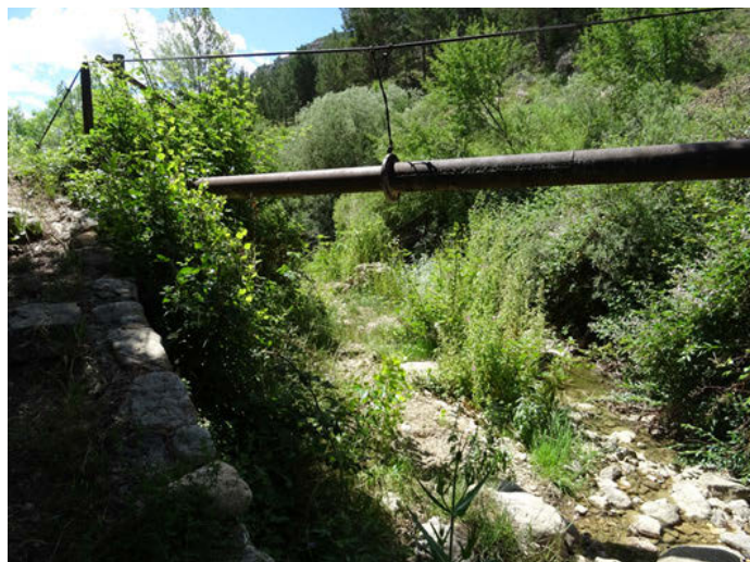
Foto 14. Conducción aérea del agua tomada en el azud 660 para regar los campos de cultivo de la ribera de Linares de Mora.
