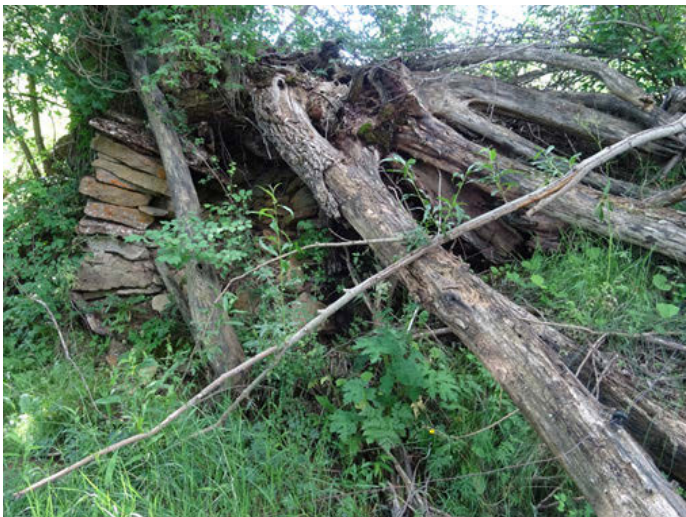
Foto 7. Fuente del Manzano en estado ruinoso (Zona 1).
