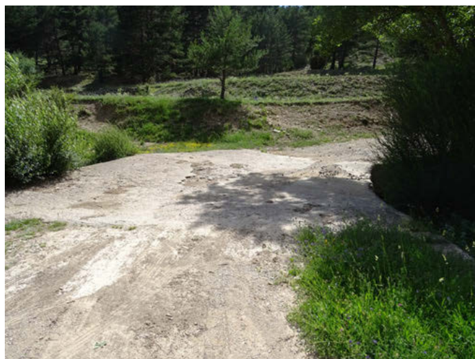
Foto 16. Paso entubado de 4 tubos en Zona 3.
