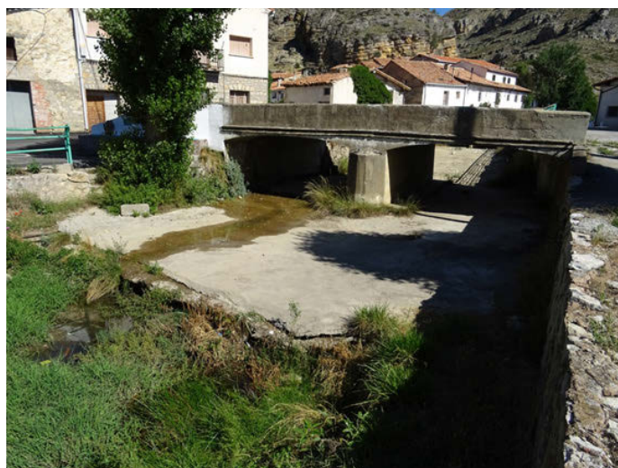
Foto 12. Azud como consecuencia del hormigonado del cauce en Villar del Cobo
