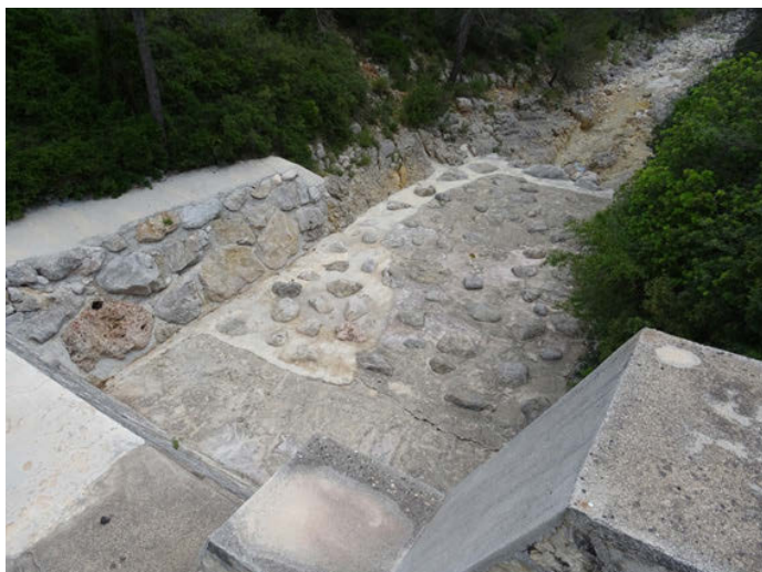
Foto 7. Dique de Vall de Laguar aguas abajo de la RNF del Río Jalón
