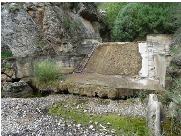
Foto 7. Azud conocido como Balsa de las Boqueras o Pisadas que se convierte en un obstáculo transversal al cauce que limita la continuidad piscícola.
