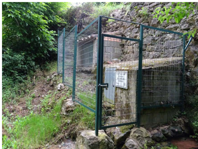
Foto 8. Captación de agua potable por parte del Ayuntamiento de Tormón, en la propia localidad.
