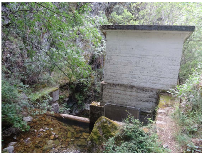
Foto 5. Captación en el río Cambrones.
