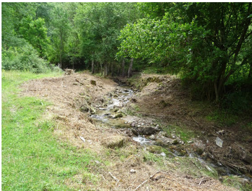
Foto 7. Desbroce de la vegetación de ribera en el río Ventrosa aguas abajo de Ventrosa (Zona 6).
