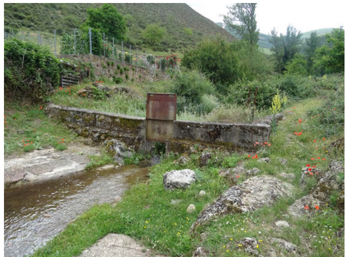
Foto 6. Obstáculo transversal con by pass manual central, ubicado en la localidad de Ventrosa.
