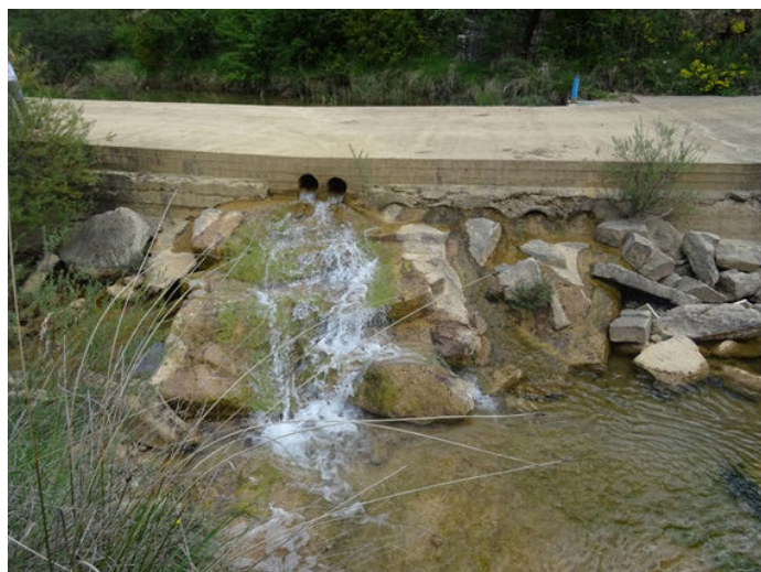
Foto 4: Paso entubado y captación de agua para abastecimiento.
