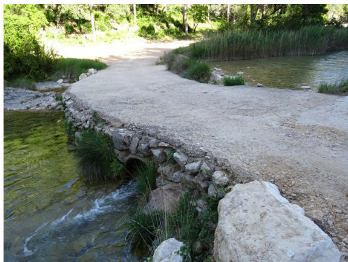
Foto 4. Paso entubado en el cruce de la pista que recorre el tramo bajo del Ulldemó.
