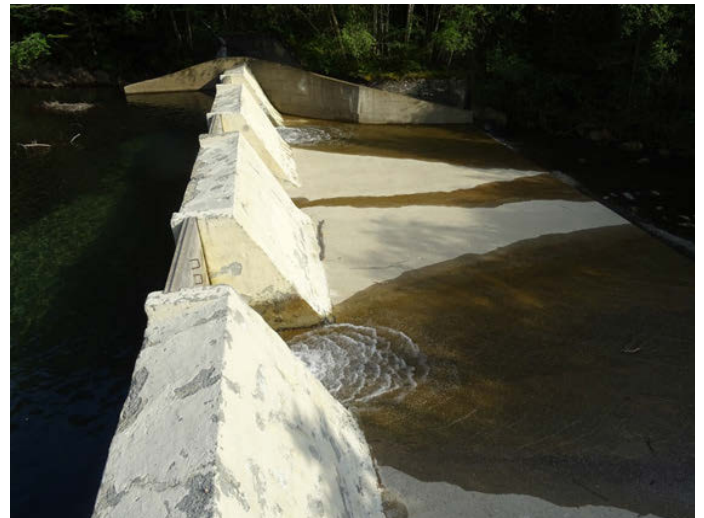
Foto 4: Presa del azud de la central hidroeléctrica de Tavascán Inferior. Al fondo, la escala de peces.
