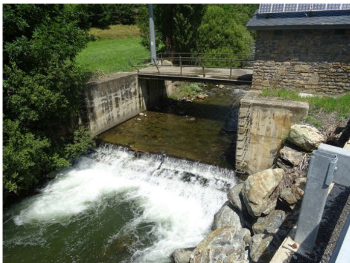
Foto 7. Estación de aforo en el final de la RNF del río Vallfarrera.
