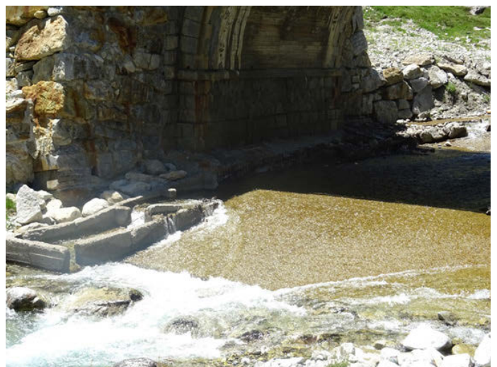
Foto 6. Escala de peces no funcional que debe adecuarse, localizada en el puente de la N-230.
