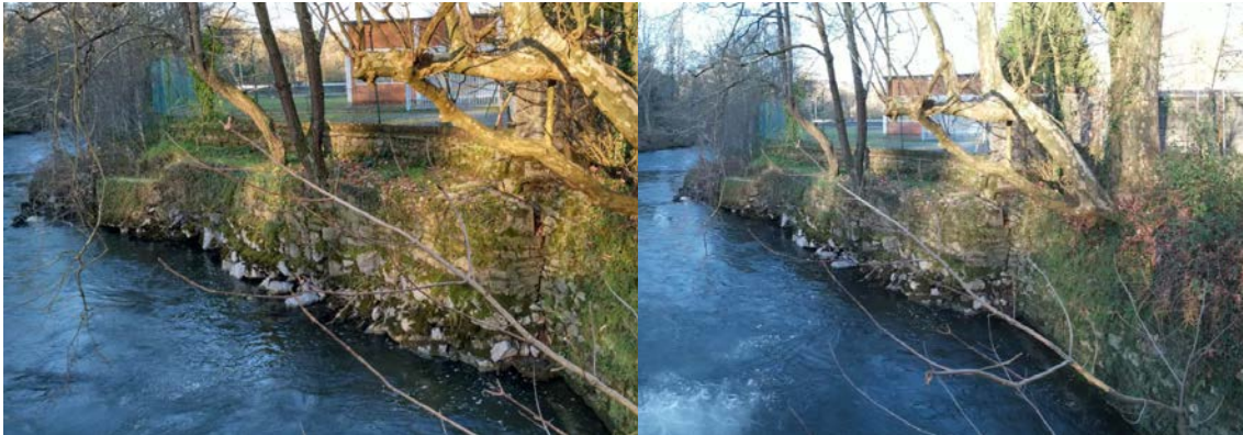
Ilustración 24 y 25 Muro derruido en la parte oeste de la fábrica
