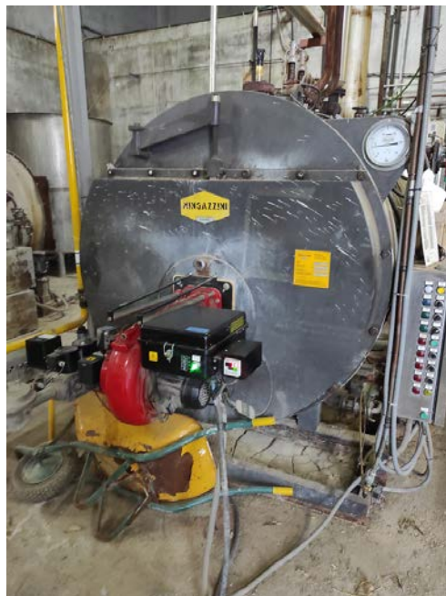
Ilustración 29. Caldera de gas natural.
