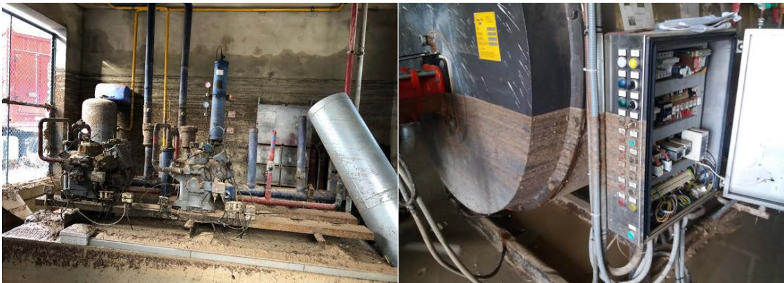
Ilustración 8. Estado de los compresores de frío (Izq) y Caldera (Drcha) después del episodio.
