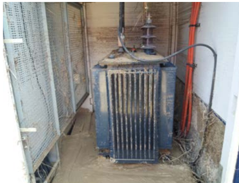
Ilustración 6. Estado del transformador después del episodio.
