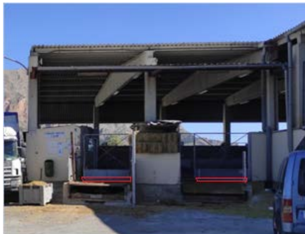
Ilustración 44. Barreras temporales en acceso norte a establos.
