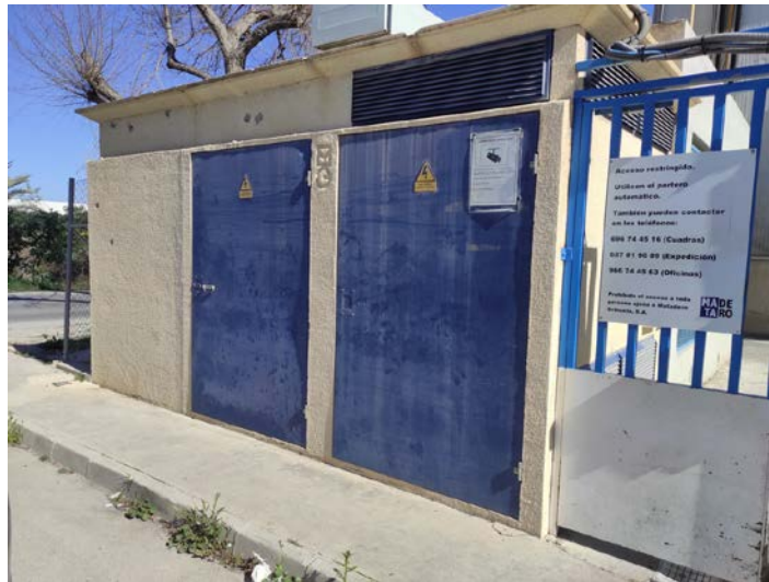
Ilustración 25. Caseta del transformador eléctrico.
