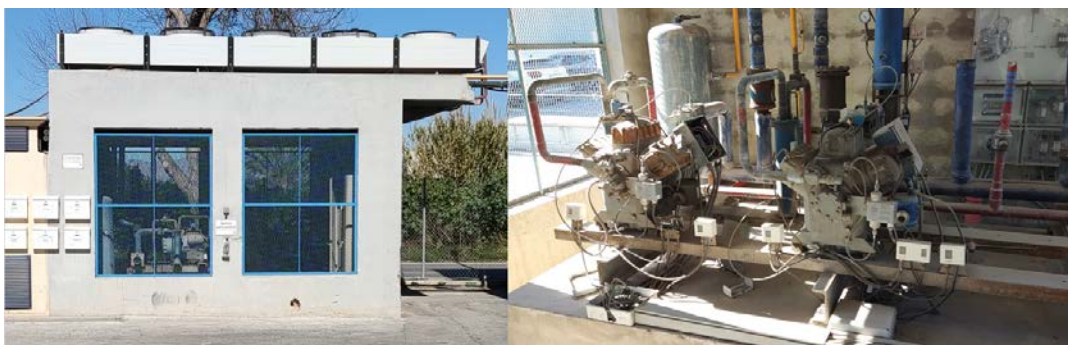
Ilustración 26. Caseta donde se ubican los compresores de frío industrial (izq.) y compresores de frío industrial (dcha.).
