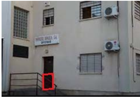
Ilustración 43. Barrera temporal en puerta de oficina.
