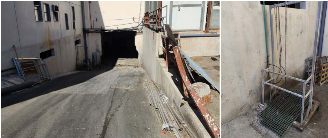
Ilustración 27. Entrada al sótano desde el exterior de la nave (izq.) y Arqueta con bomba de achique (dcha.).
