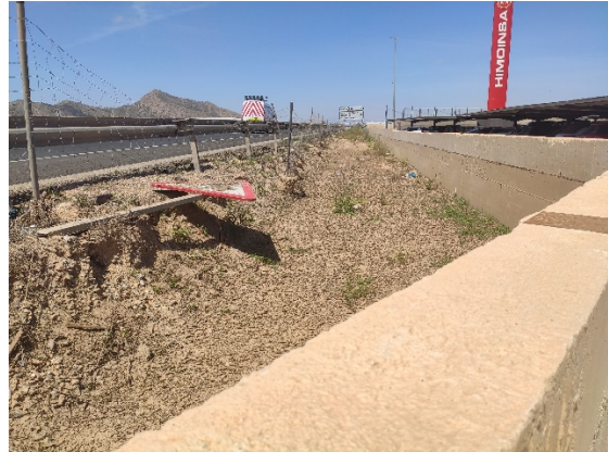
Ilustración 34 Cuneta carretera exterior al vallado
