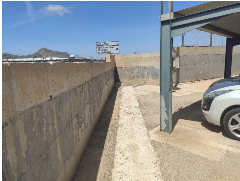
Ilustración 37 Sistema de drenaje eliminado
