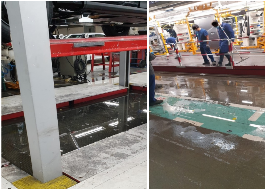
Ilustración 8: nave F, pequeñas inundaciones
