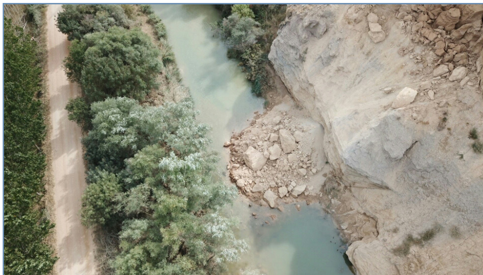
Foto 7. Deslizamiento de ladera sobre el río Ega en Carcar (Navarra) que disminuye la capacidad de desagüe del mismo.
