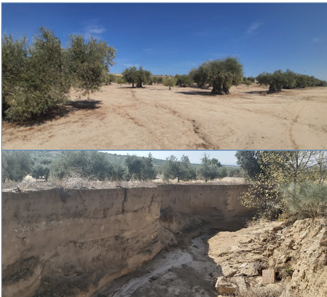
Foto 10: Una inadecuada gestión de la cuenca hidrográfica puede derivar en importantes modificaciones de los cauces asociados. Ejemplo de la gestión del olivar en Cebolla (Toledo) y su impacto en el arroyo de Sangüesa (cuenca del Tajo).
