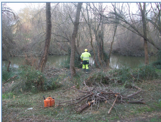
Foto 13. Trabajos selvícolas de retirada de un tapón de restos vegetales en el río Manzanares.
