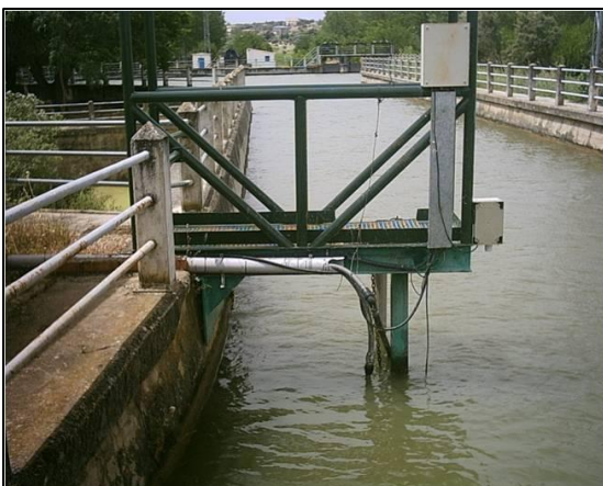
Ilustración 2: Sistema de captación de agua del río.
