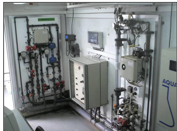
Ilustración 3: Analizadores de parámetros específicos.
