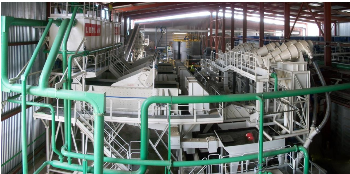
Ilustración 4: Interior de la planta de tratamiento.
